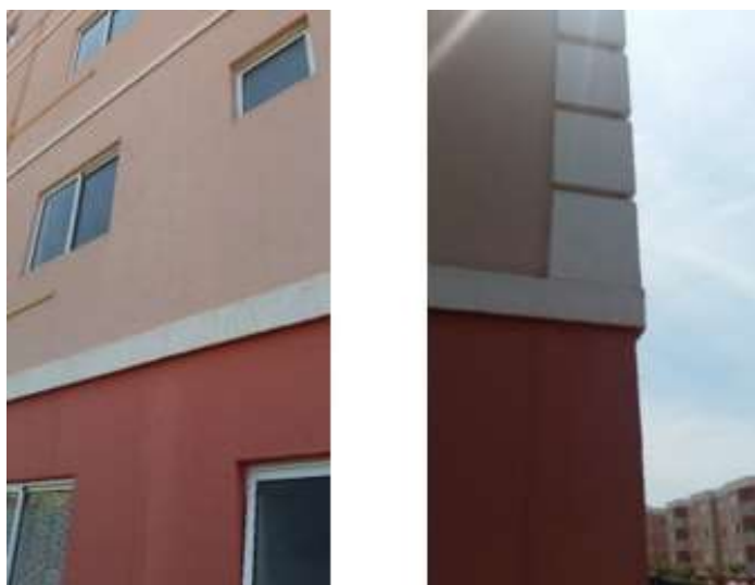
Fig. 2.37 – Encontro entre Painel Estrutural e Laje da Empresa A Fonte: Acervo próprio (2017)
