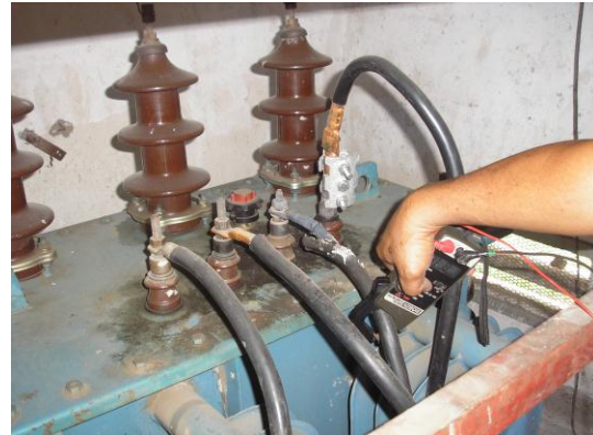
Gambar 4. Foto Pengukuran Arus Pada Trafo
