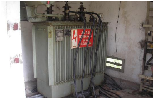
Gambar 2. Foto Trafo Distribusi P70
