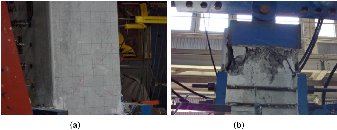
Gambar 8. Kolom C-1R: (a) Retak pada Daerah Sendi Plastis, (b) Retak dan Spalling pada Ujung Kepala Kolom
