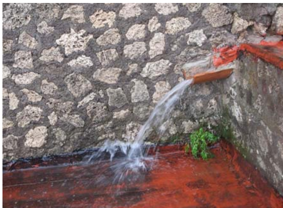
Fig. 4. Pompei, Casa della Fontana Piccola. Inefficienze nei sistemi di allontanamento delle acque piovane.
