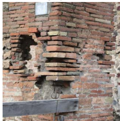
Fig. 5. Pompei. Carenti manutenzioni mettono in pericolo la stabilità delle murature.
