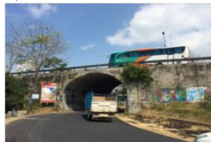
Gambar 3. Lintas atas di jalan menggunakan struktur baja bergelombang tipe 152 by 51 di lingkas Tasikmalaya (Aldiamar dkk. 2015)
