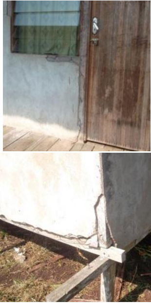
Gambar 8. Kondisi kerusakan pada bidang dinding yang menempel pada rangka kayu
