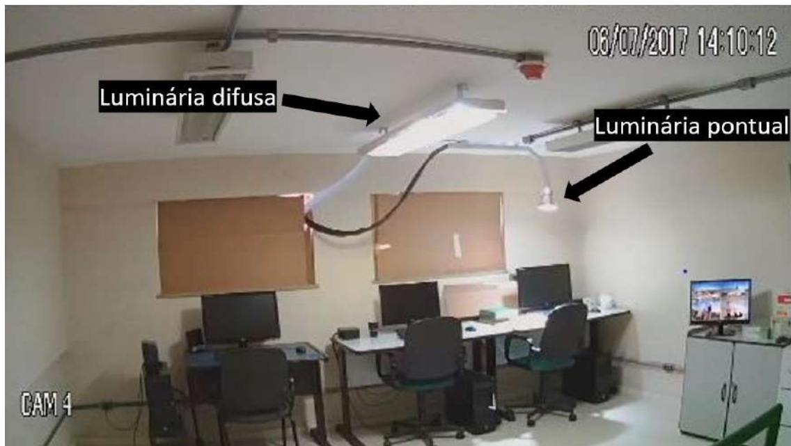
Figura 40 - Sala iluminada pelas luminárias pontual e difusa
