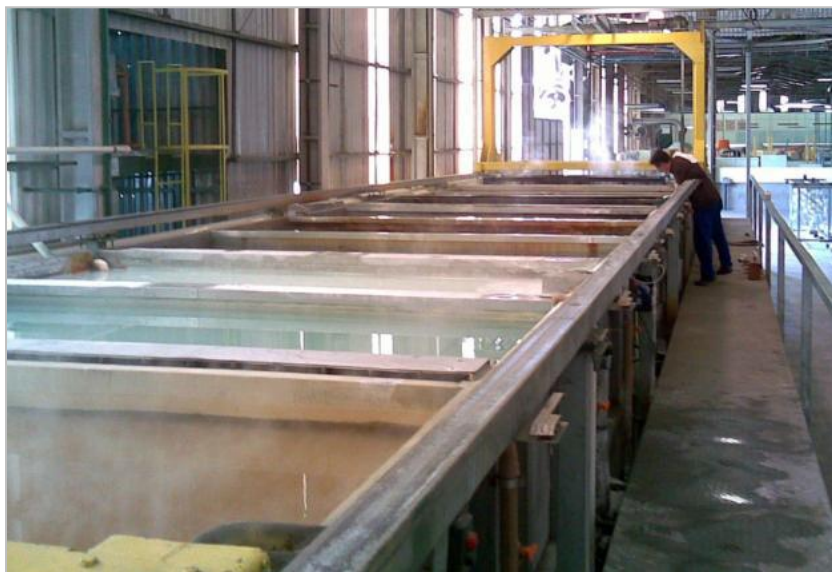
Fig. 42: Reservatórios de uma linha de fosfatização.
