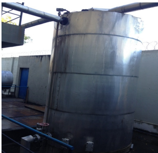
Figura 4 - Tanque de sedimentação do HFO.
