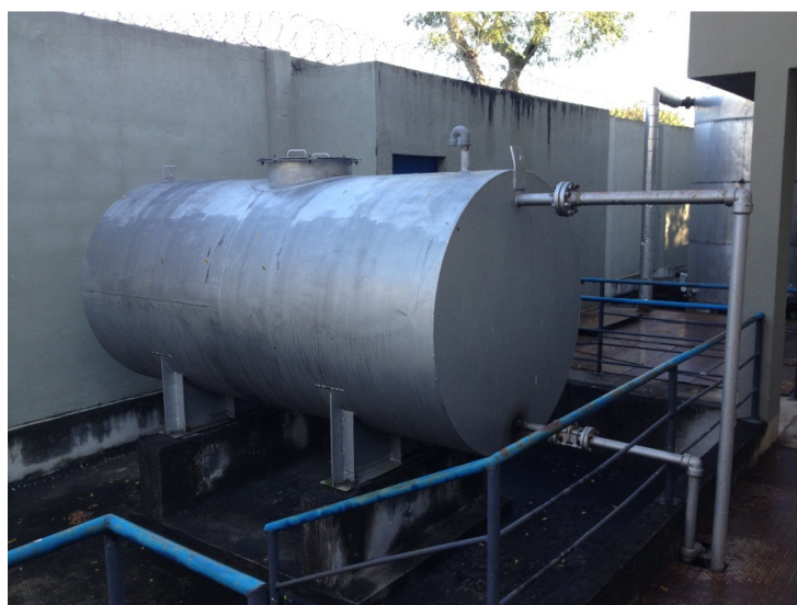
Figura 6 - Tanque de armazenagem do MDO.
