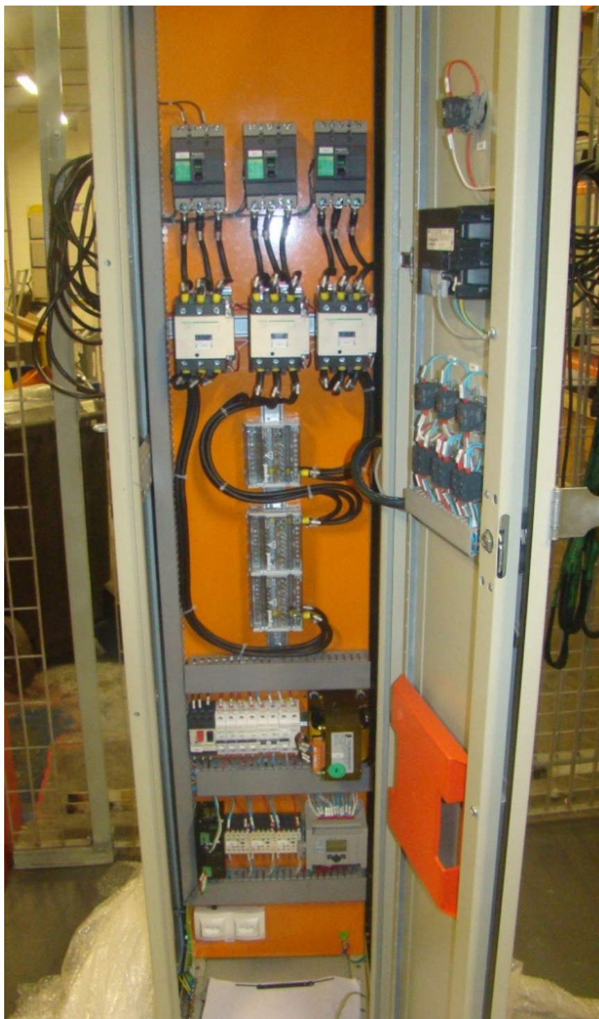
Figura 26: Painel auxiliar com visão dos componentes internos.
