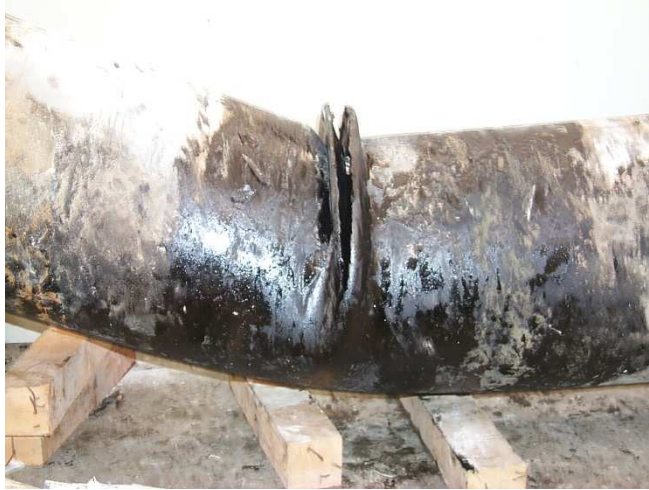
Figura II-9 – Flambagem local de um duto - [5].
