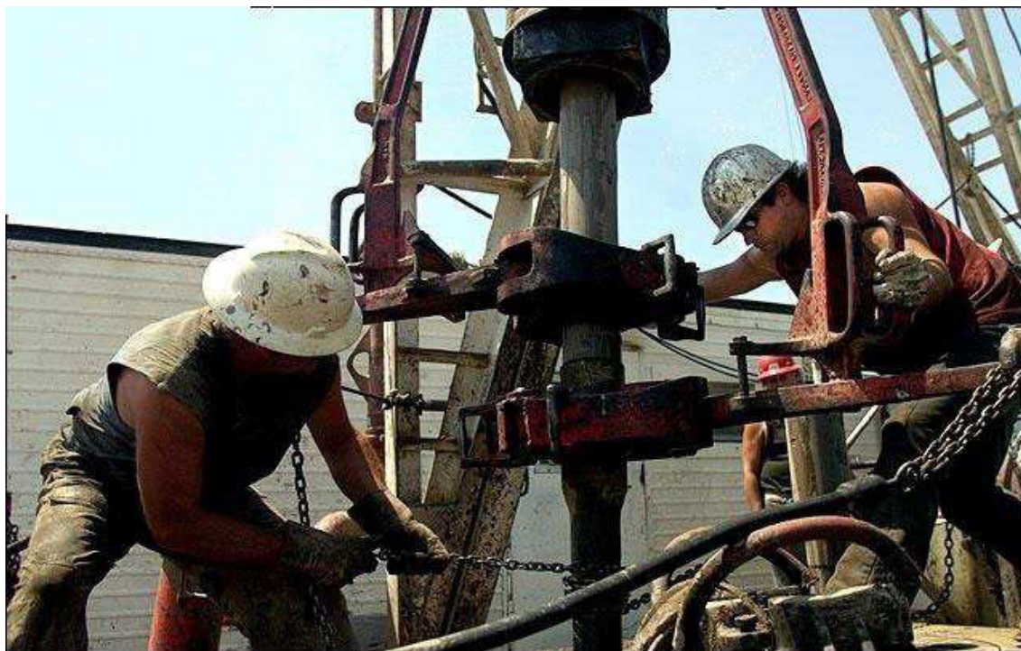
Figura 58 – Dois plataformistas utilizando as chaves flutuantes para quebrar o torque e desfazer a conexão do Kelly no Drill Pipe. Na parte inferior do drill pipe, nota-se a corrente enroscada, usada para rapidamente desenroscar os tubos já com o torque quebrado. ( http://www2.ljworld.com/photos/2005/jul/10/60927 )
