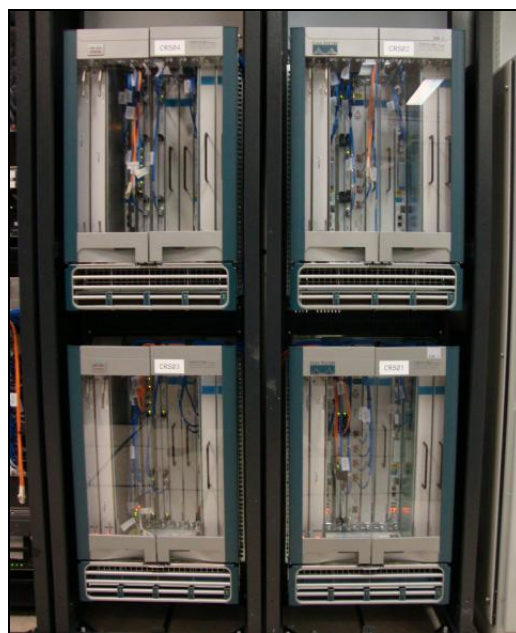
Figura 4.4: Conjunto de roteadores de Core do Backbone IP do CRT
