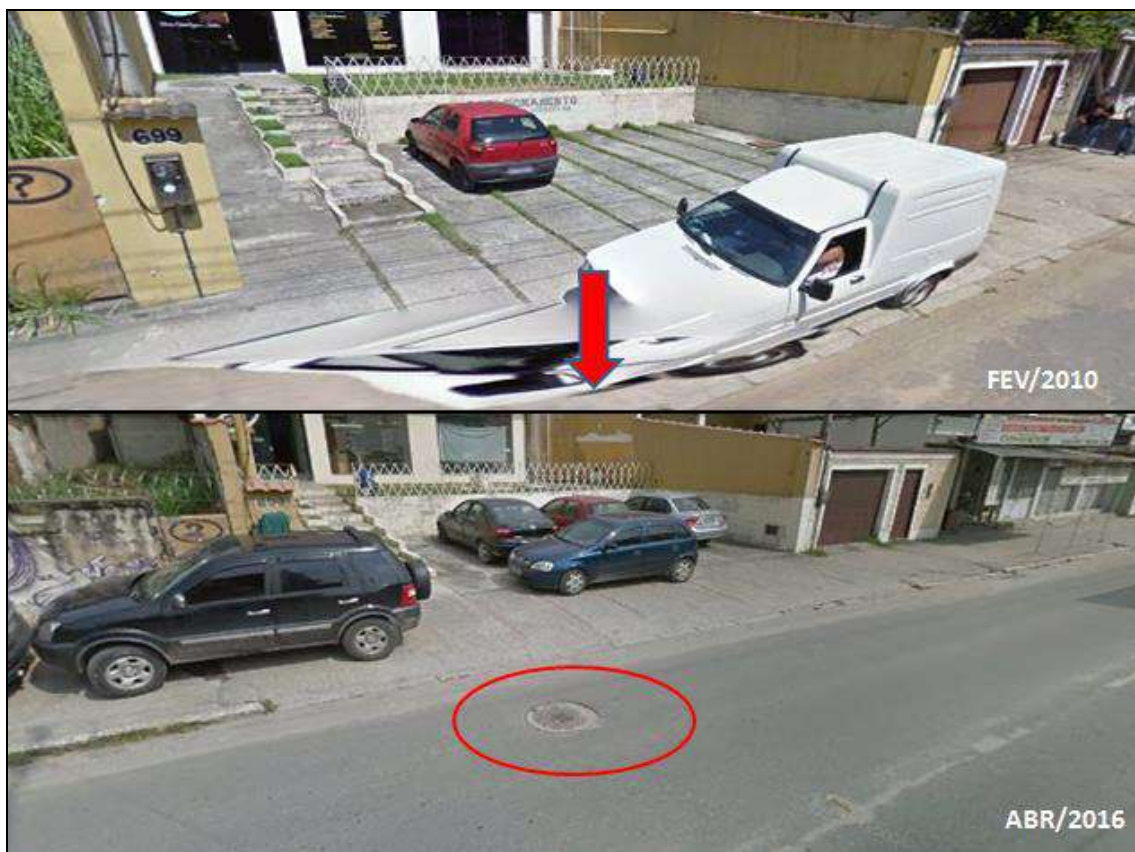
Figura 39: Bueiro com desnível
