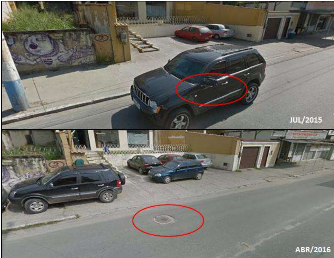
Figura 41: Caso de bueiro com desnível
