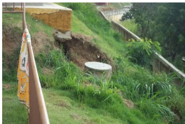
Figura 31- Rachaduras na estrutura e Vazamento na caixa de esgoto (Imagem mais aproximada)
