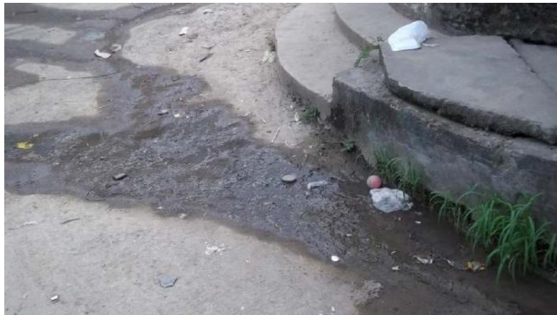
Figura 12 - Rua Osvaldo Pereira, Bairro Arsenal (Esgoto a céu aberto)
