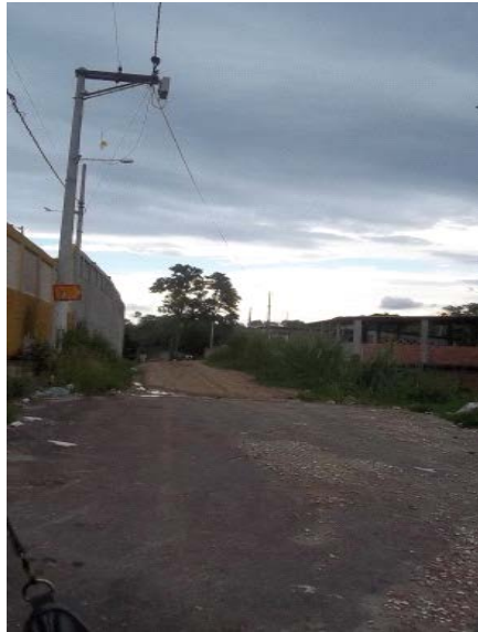
Legenda: Asfalto cedendo na Rua Santa Fé (subida) Fonte: Acervo Pessoal Pesquisa de Campo 17 e 18 de janeiro de 2013
