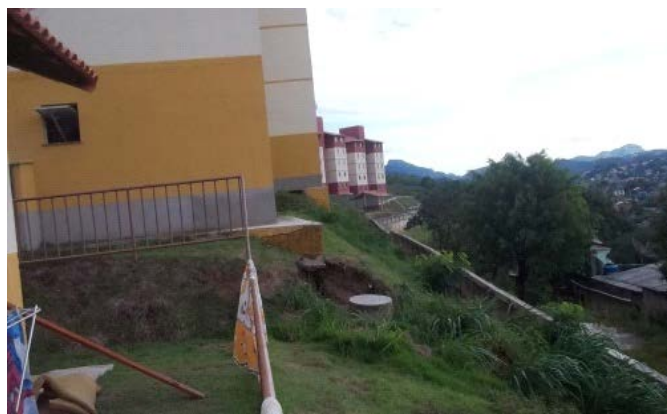
Figura 30- Problemas na estrutura do condomínio
