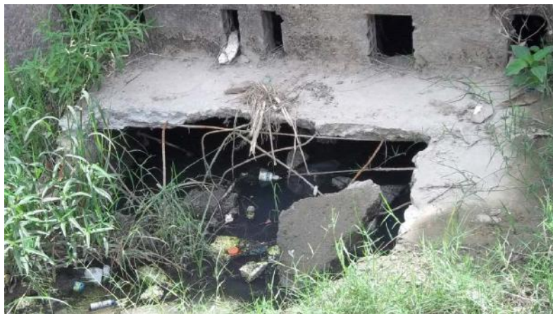
Figura 13 - Rua Nívia Nascimento, Bairro Arsenal (Esgoto a céu aberto)
