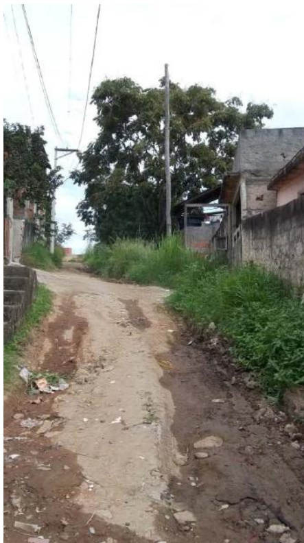
Figura 08 - Rua Santa Fé - Bairro Arsenal (Via sem pavimentação)
