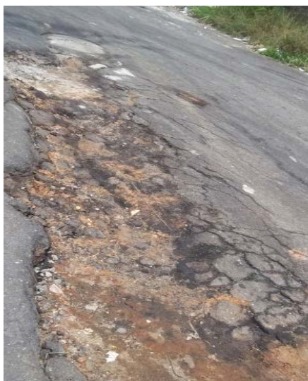
Figura 26 - Pavimentação precária na Rua Santa Fé
