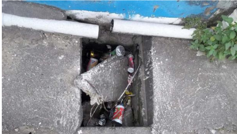
Figura 10 – Rua 15 de novembro, Bairro do Arsenal (Esgoto lançado nas galerias de águas pluviais)
