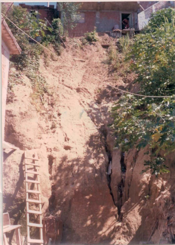
FOTO 28 - Formações de ravinas por erosão em taludes de solo residual saprolítico.
