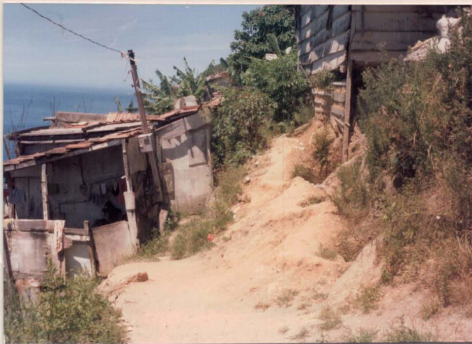
FOTO 25 - Habitações precárias na unidade colúvio/rocha contribuindo ainda mais para a desestabilização do local.
