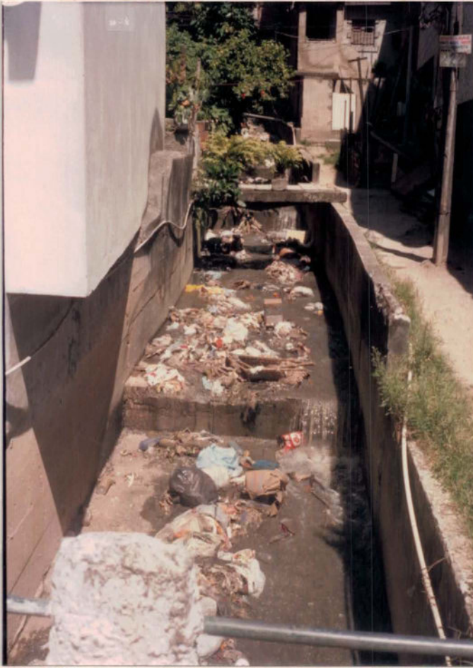
FOTO 29 - Lixo despejado aleatoriamente no valão.
