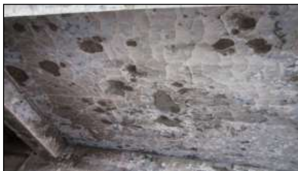
Gambar 5: Kondisi ruangan A1
