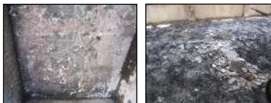
Gambar 7. Spalling dan Terkelupasnya Plesteran
