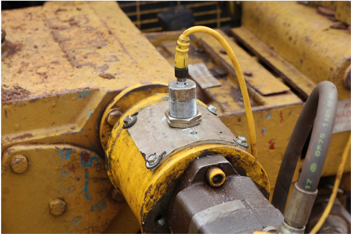
Figura 7.10 - Sensor de pressão instalado na saída da bomba de lama (Fonte: o autor)
