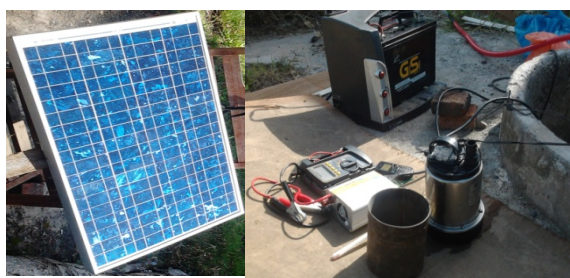
Gambar 2. Peralatan pengukuran unjuk kerja pompa air-tenaga surya
