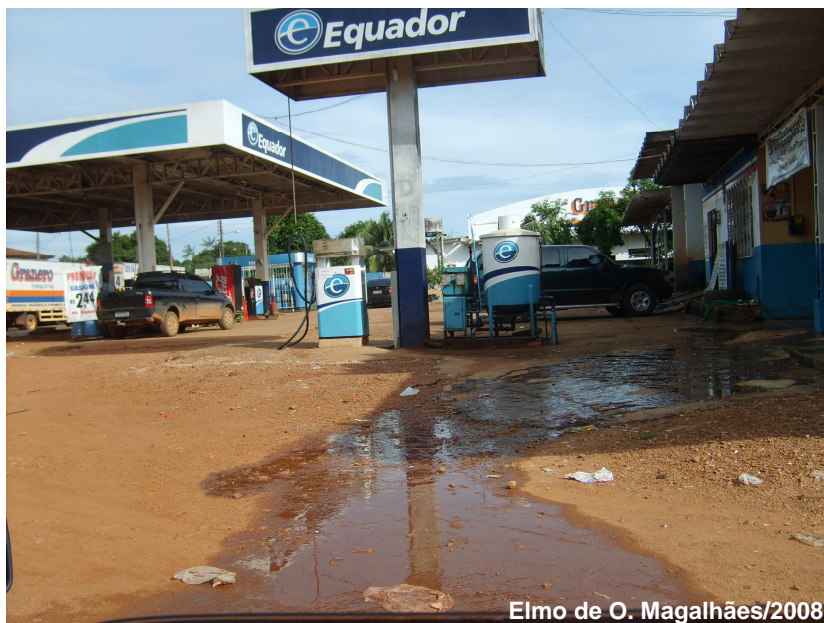
Figura 43: Posto com piso irregular e sem sistema de canaletas proteção.
