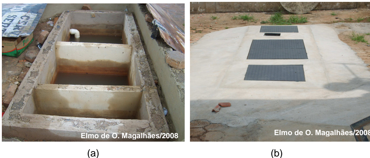
Figura 27: (a) Caixa separadora em alvenaria em fase de construção; (b) Caixa separadora de 3 estágios já padronizada
