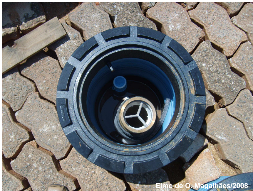
Figura 32: Vista superficial da câmara de contenção e no interior a Descarga Selada aberta
