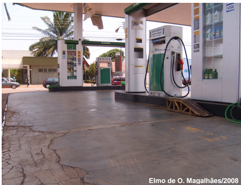
Figura 36: Piso da área de abastecimento necessitando de reparos
