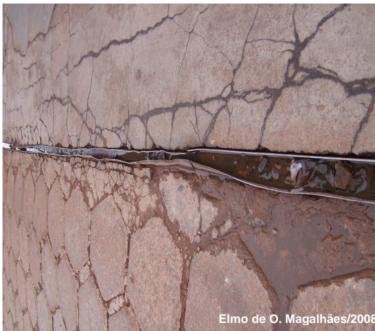
Figura 44: Sistema de canaletas e piso necessitando de reparos e adequação
