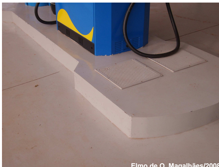
Figura 39: Ilha de contenção dentro das especificações
