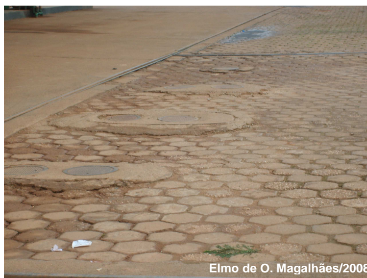
Figura 38: Área de descarga com piso fora da especificação e sem proteção de canaletas.
