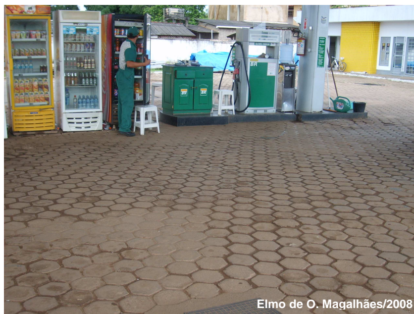
Figura 42: Área de abastecimento com piso irregular e sem proteção de canaletas
