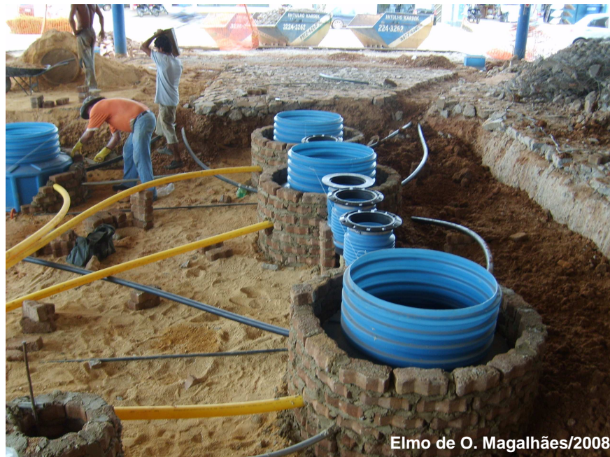
Figura 12: Tanques ecológicos com dispositivos de contenção já instalados
