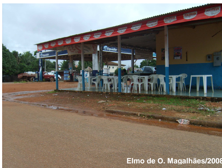
Figura 15: Restaurante do PRC com piso danificado na área de abastecimento
