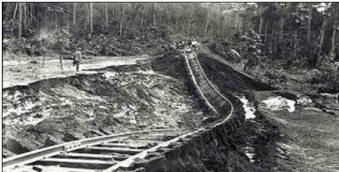
Imagem1 - Trecho da ferrovia destruído pelas chuvas em 1910
