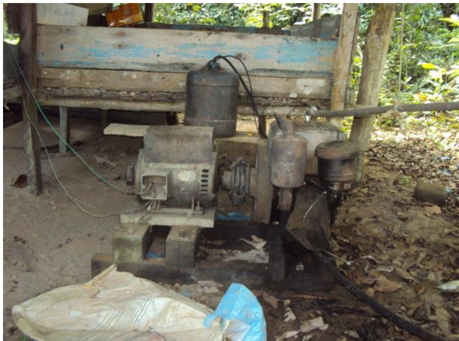
Figura 12: Vista do gerador com ligação monofásica 110 volts.
