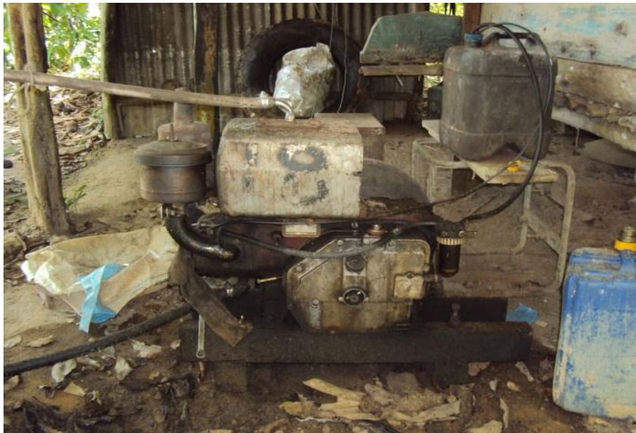
Figura 13: Vista do motor com o tanque diesel e parte tubulação do radiador.
