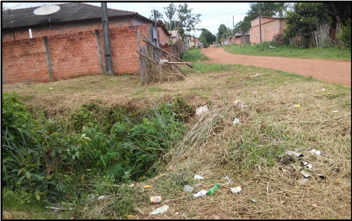
Figura 18: Bairro Socialista. Observa-se o canal com a presença de lixo, assim como a rua estreita.
