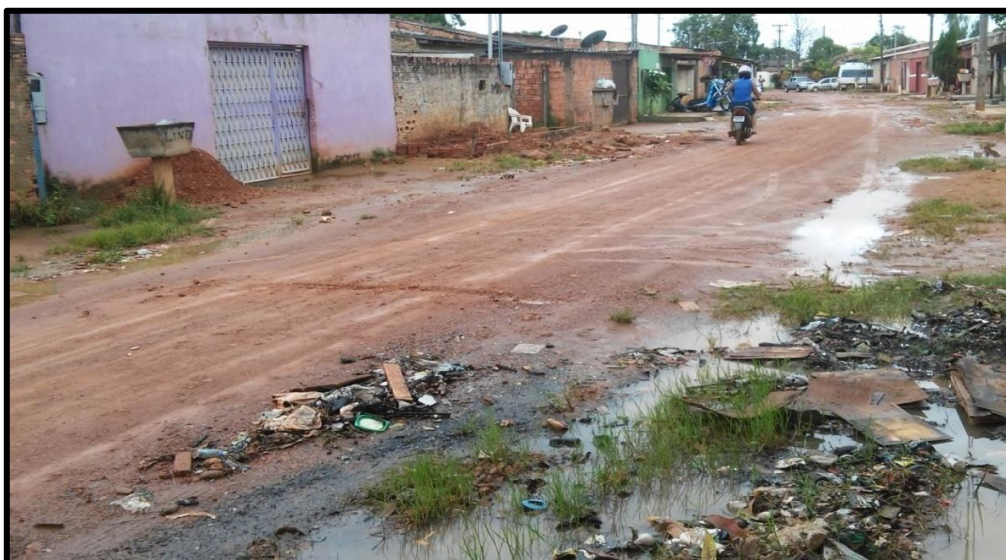
Figura 13: Rua Henrique Valente, bairros Três Marias. Observa-se a presença de muito lixo ao longo da rua, com lama uma espécie de esgoto a céu aberto devido à falta de drenagem urbana, o que dificulta o escoamento da água da chuva. Foto Silva 19/01/2015.
