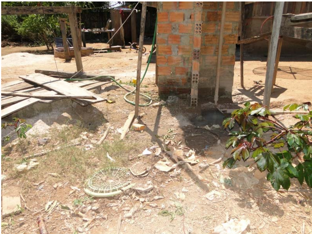
Foto 4 – Poço a 5 metros da Fossa Negra Autor da foto: Charles da Silva Barata
