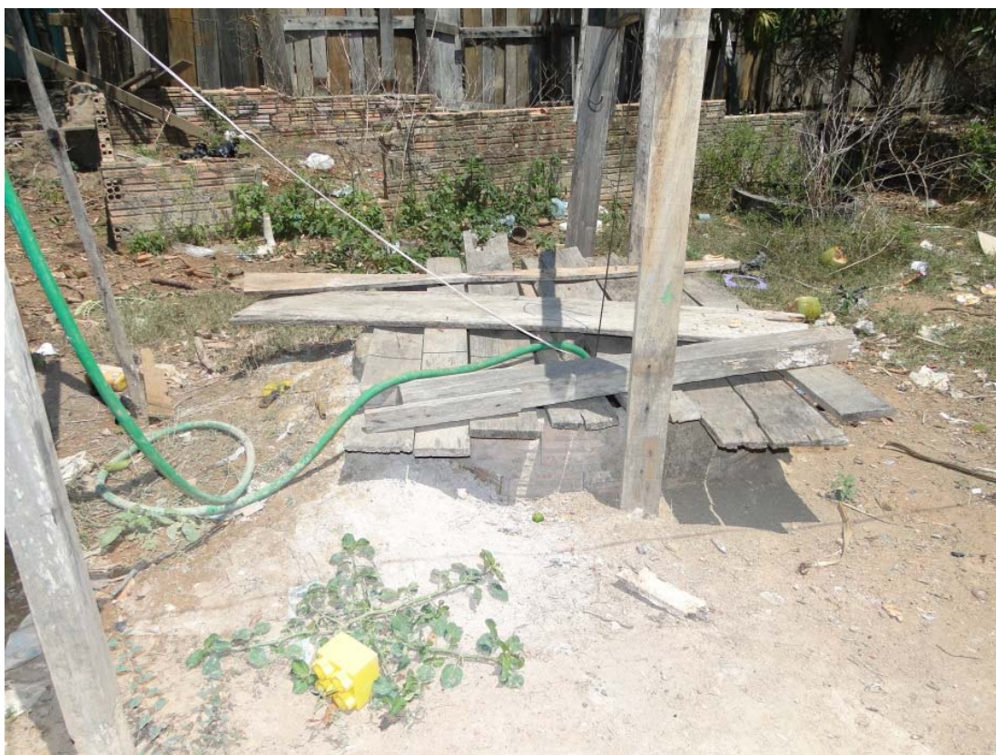
Foto 7 – Tampa de madeira, permitindo a entrada de água de chuva. Autor da foto: Charlles da Silva Barata
