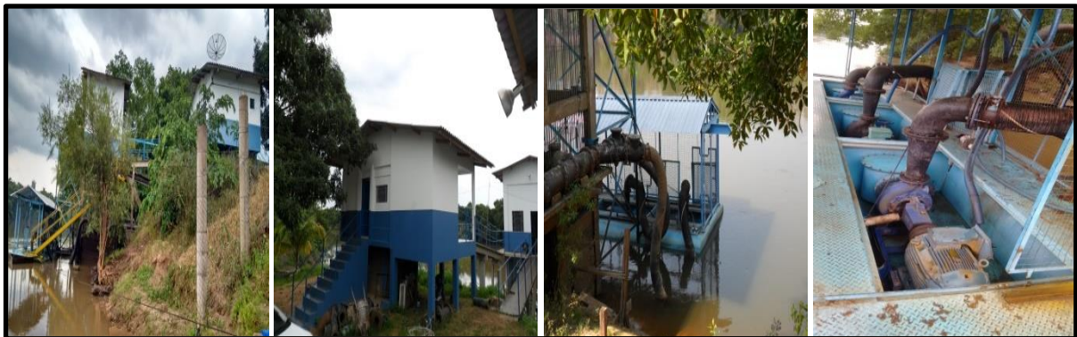
Figura 4: Estação de Captação Fonte: Pesquisa (2015)
