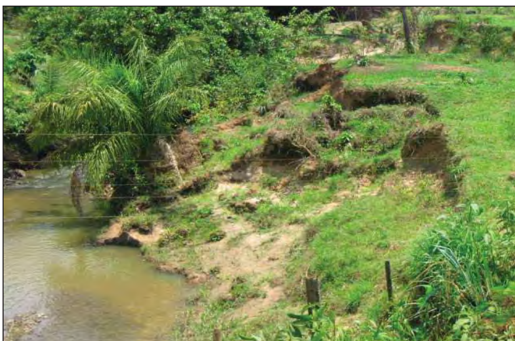
Figura 46: Processo erosivo no Rio Caixão Sem Fundo - Corumbiara
