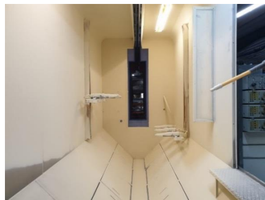
Figura 11. Cabina de aplicación de pintura.
