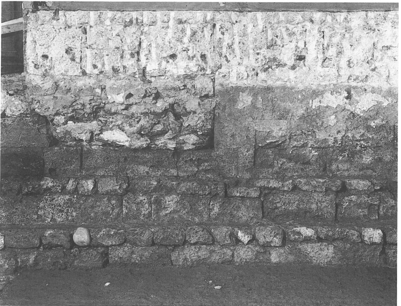
Abb. 7: Ansicht an die Südwand des romanischen Schiffes (mit den Strukturen des älteren südlichen Eingangs).
