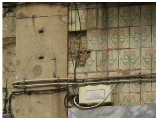
Figura 6 - Fachada azulejada com problema de perda de coesão da argamassa de assentamento
