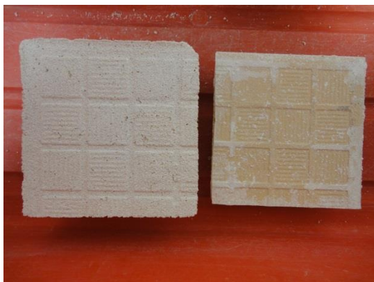
Figura 14 – Rotura adesiva pela interface azulejo/argamassa
