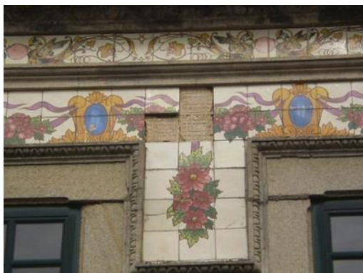
Figura 5 - Fachada azulejada com problema de perda de aderência da argamassa de assentamento
