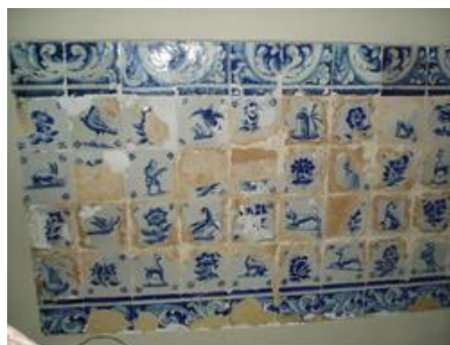
Figura 8 - Anomalia provocada pelo uso de uma argamassas de ligante hidráulico no assentamento de um painel azulejar
