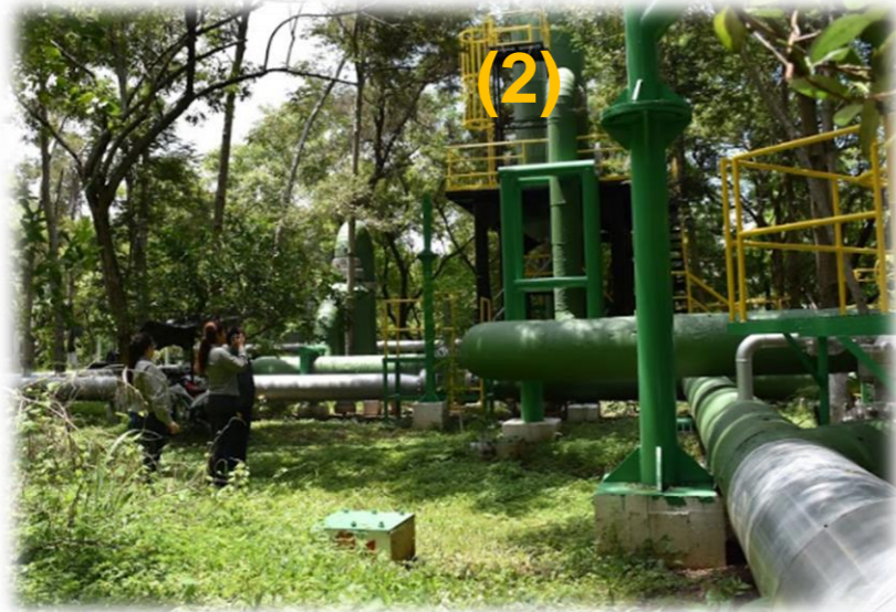
2) Vibraciones en separador ciclónico
