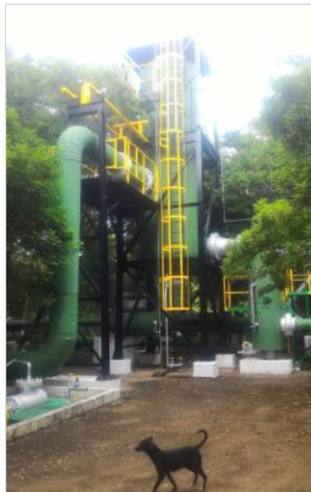
Fig. 8 Vista alzada de estación de separación tipo Webre de 550 tph.
