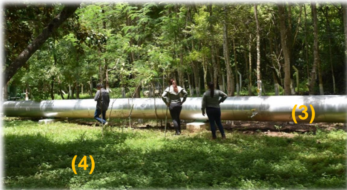
3) Caída de presión en tubería de conducción; 4) Suelo saturado con agua;
