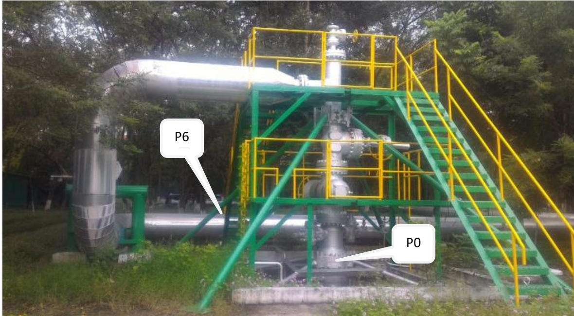
Fig. 7 Vista alzada del árbol del contrapozo AD-4Bis. El punto P0 y P6 representa el tramo de tubería analizada con mayor nivel de vibración según mediciones in-situ.
