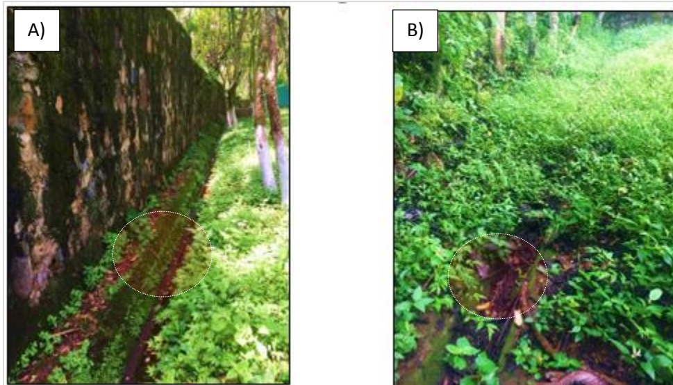
Fig. 30 A) Canaleta Sur, de 98m de longitud B) Canaleta Este, de 15m de longitud.
