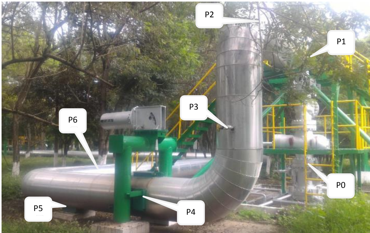
Fig. 10 Sistema de tubería para transporte de flujo bifásico analizada. Los puntos indicados representan la ubicación del sensor para medición de velocidad y amplitud de la vibración.
