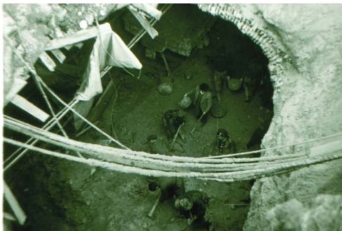
Figura 9. Socavón en la Puerta del Sol 11
