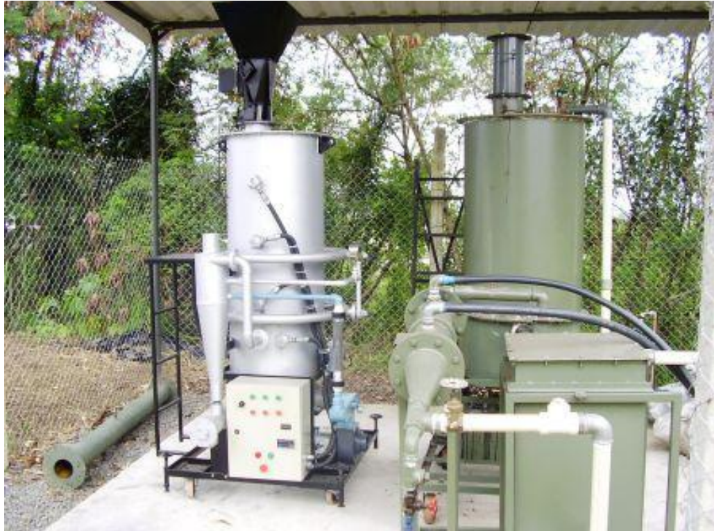
Figura 3.20. Gaseificador Downdraft de Biomadssa de 30 kW instalado na Fac. De Engenharia de Guaratimhiuetá – FEG – UNESP (Coronado, 2007).
