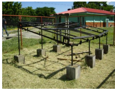
Figura 2.13: Como se encontraba la estructura al inicio de este proyecto.
