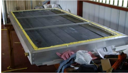
Figura 2.34: Colector con las Tes, fibra de vidrio y placas de aluminio.
