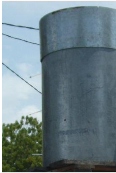
Figura 3.76: Tres termómetros a diferentes alturas en el tanque acumulador.
