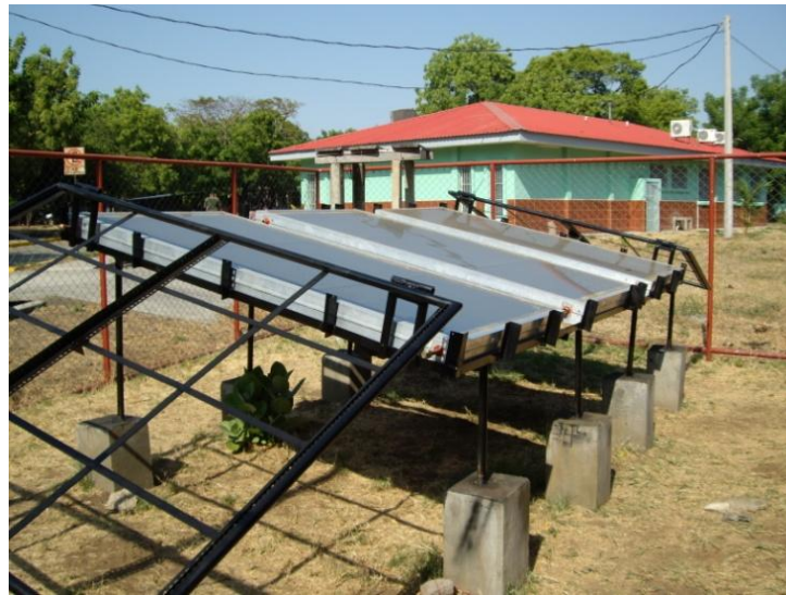
Figura 3.77: Los tres colectores sobre su estructura.
