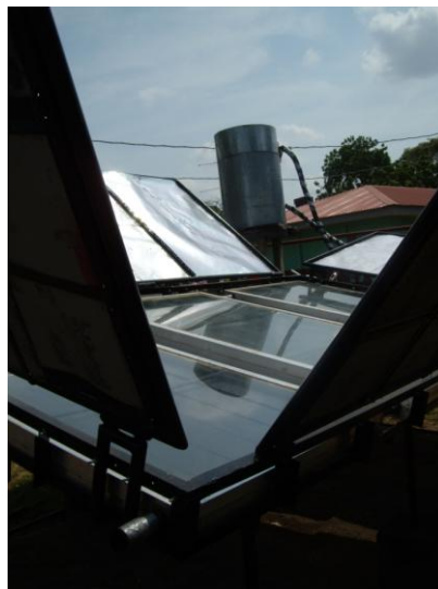
Figura 2.63: Foto del circuito primario construido en Nicaragua.
