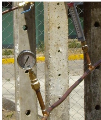
Figura 3.50: Detalle del termómetro y manómetro.
