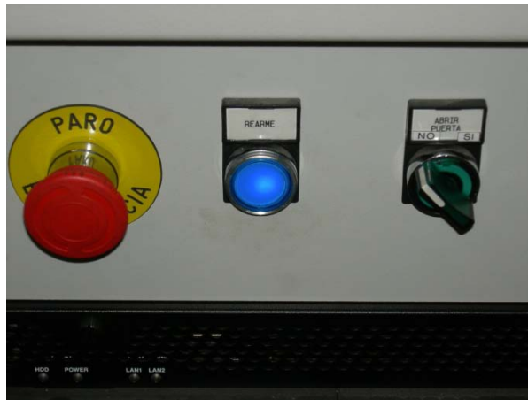
Figura 3.23: Interruptor de petición de entrada (“ABRIR PUERTA”) en armario de control.
