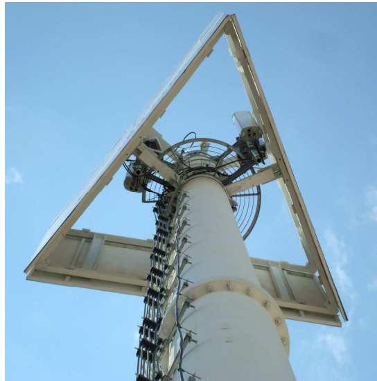
Fig.2.23 Mimetizado en torre monopolo o tubular
