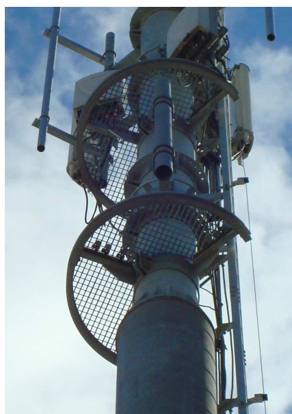
Fig 2.20 Plataforma de trabajo y descanso en torre tubular
