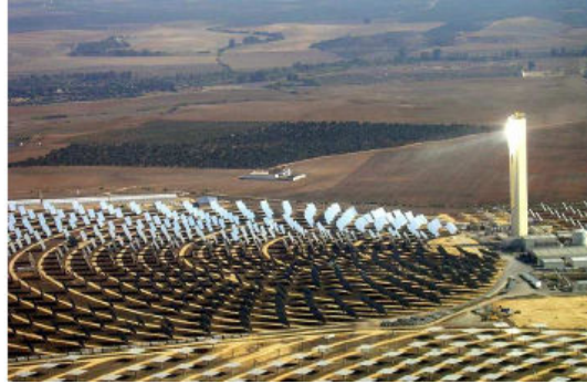
Figura 3. Parque de helióstatos en Almería.
