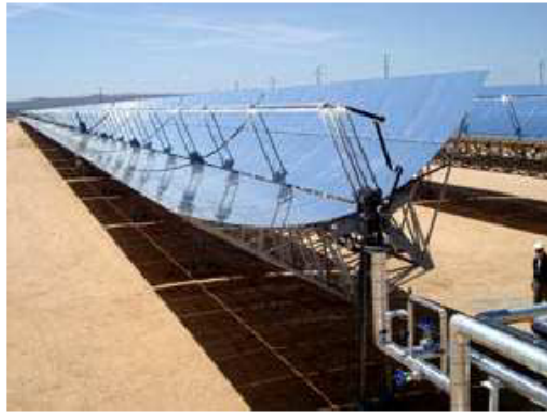
Figura 1. Colector cilíndrico parabólico.
