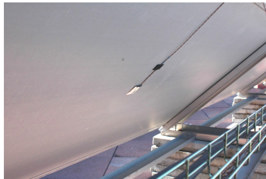
Figura 4-24: Termopar situado en la caja del captador (parte trasera)
