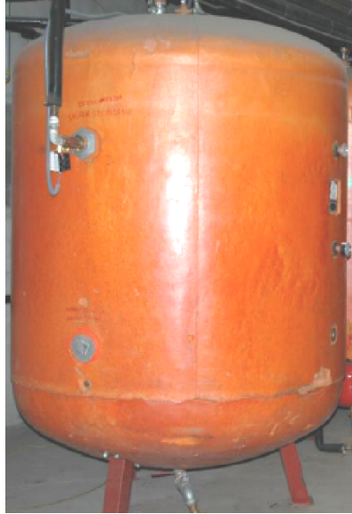
Figura 4-8: Acumulador térmico de acumulación de 3000 litros
