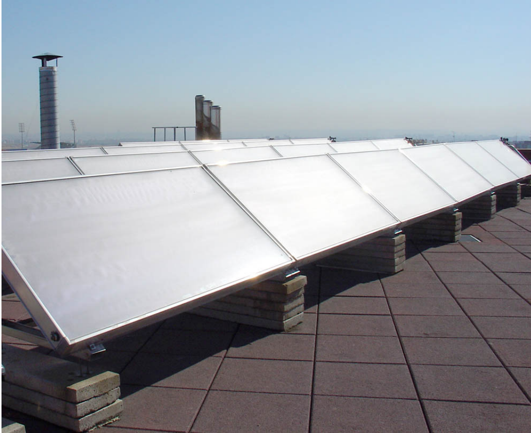
Figura 4-2: Vista general del campo de 50 m 2 de captadores solares planos, instalado en la UC3M.
