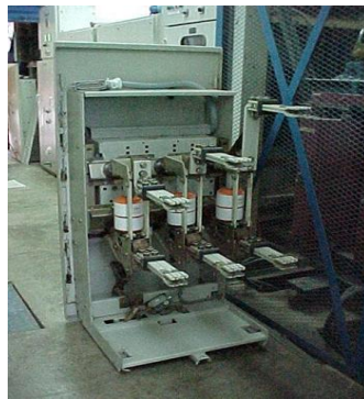
Fig.5. Interruptor magnetotérmico A.T
