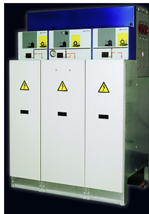
Fig.4. Celda situada en subestación distribución.
