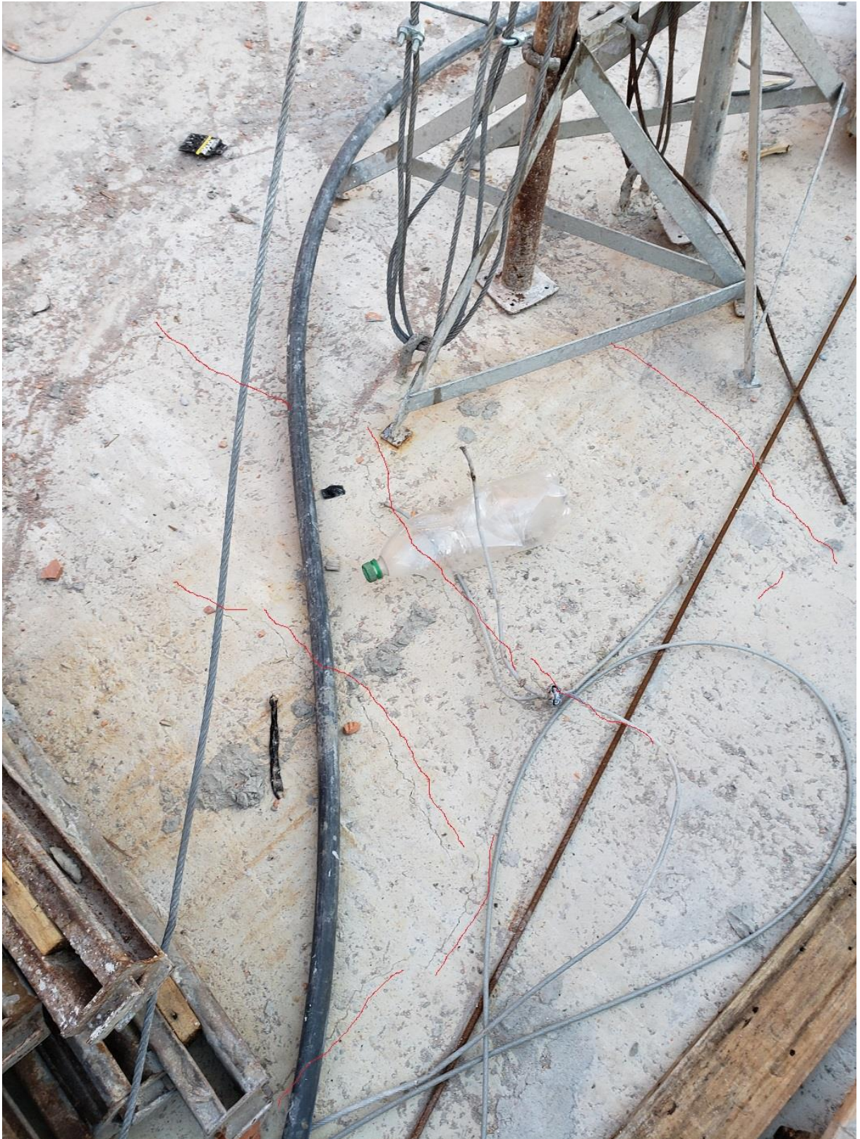
Figura 37 - Fissuras na laje de cobertura em edifício em Capão da Canoa - foto 2
