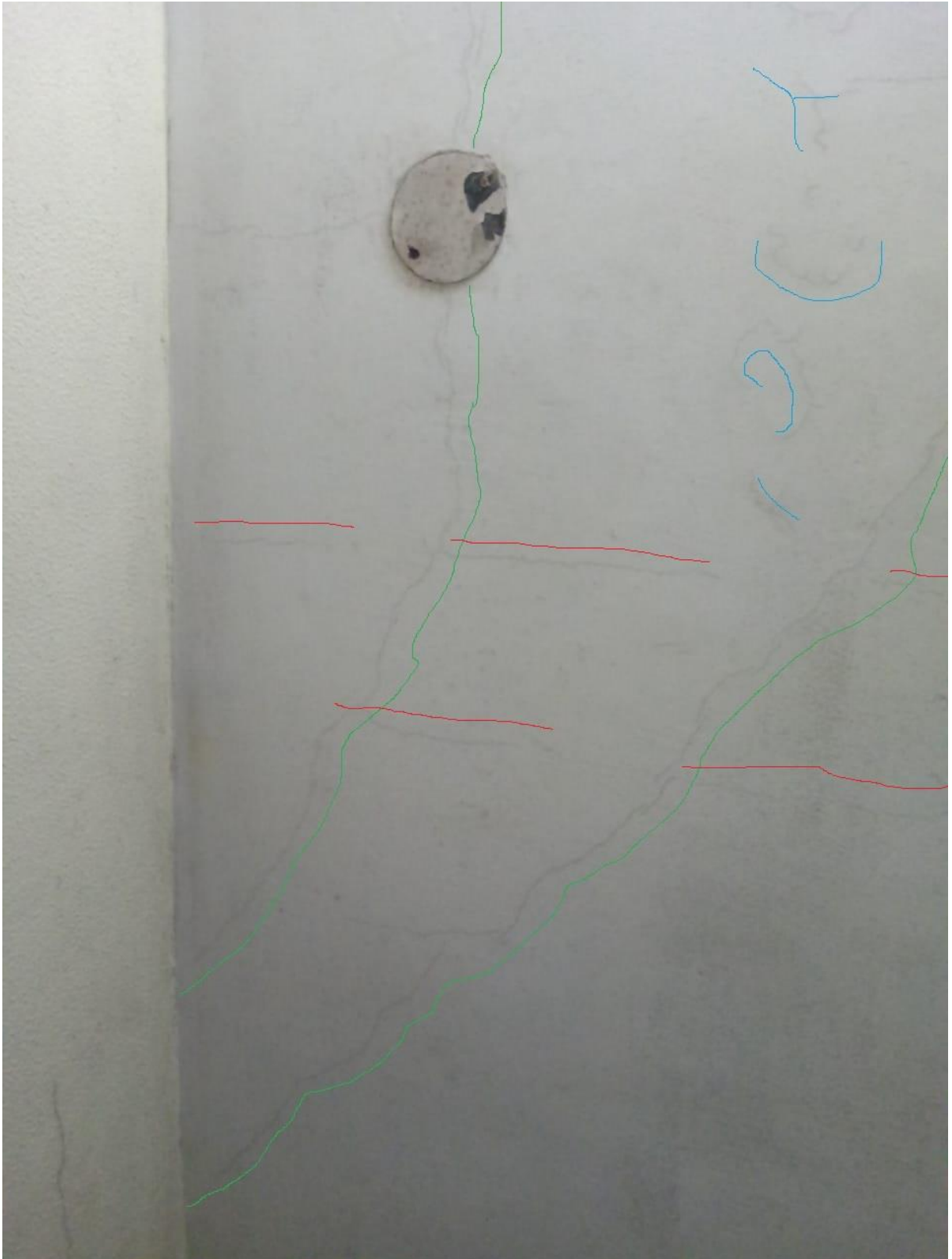
Figura 46 - Fissuras localizadas no corredor de acesso aos apartamentos - foto 6
