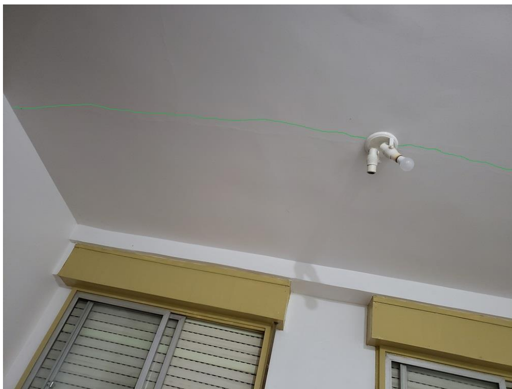
Figura 48 - Fissura situada na laje do apartamento - foto 2
