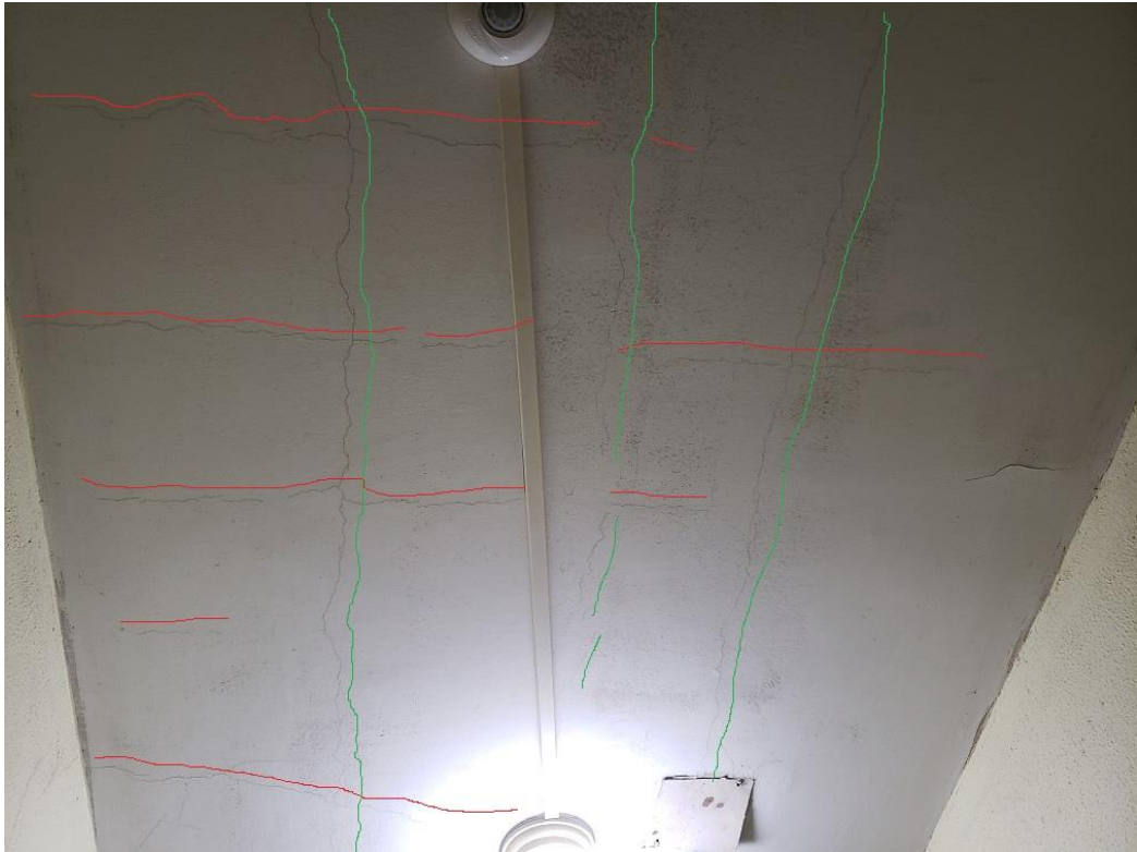
Figura 43 - Fissuras localizadas no corredor de acesso aos apartamentos - foto 3
