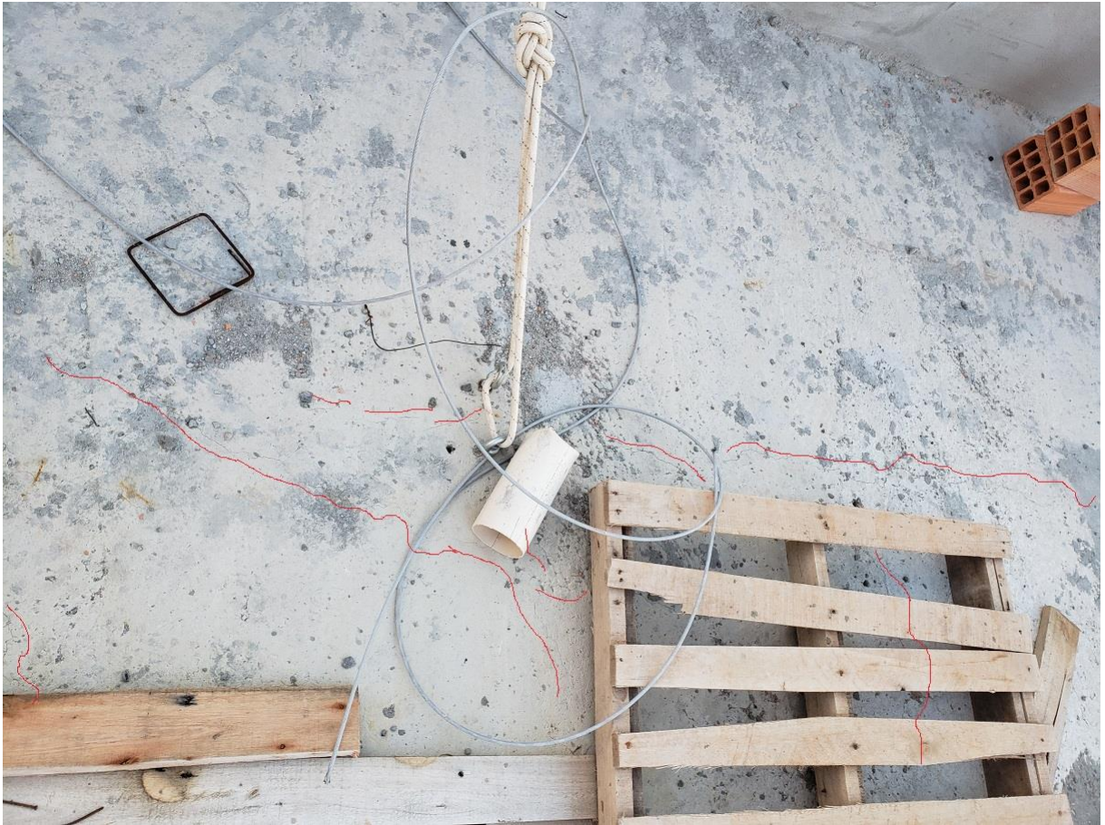
Figura 38 - Fissuras na laje de cobertura em edifício em Capão da Canoa - foto 3
