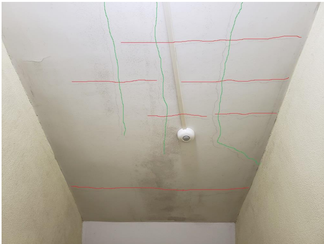
Figura 44 - Fissuras localizadas no corredor de acesso aos apartamentos - foto 4
