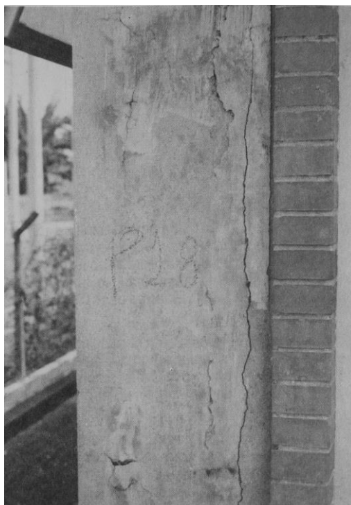
Figura 22 – Fissuração acentuada e lascamentos em pilar de concreto, devidos à corrosão das armaduras.
