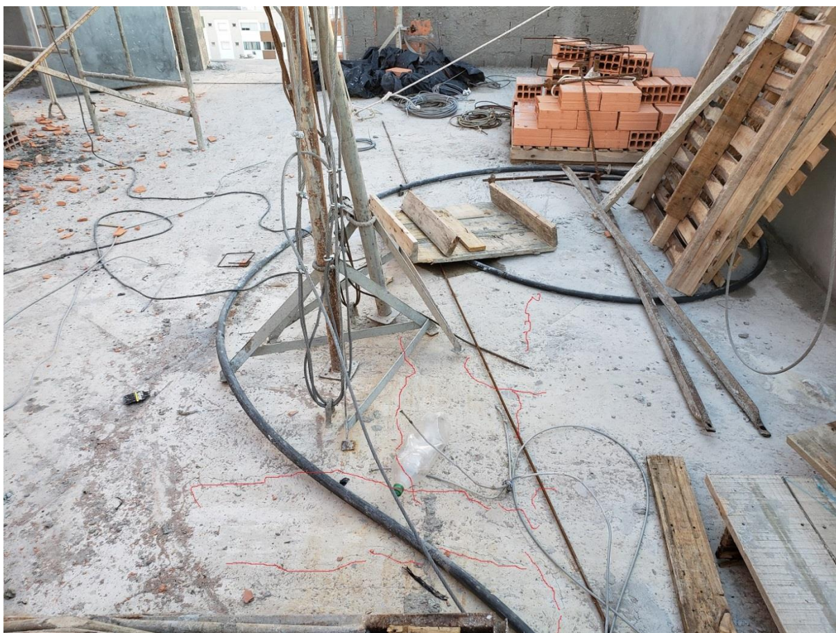
Figura 40 - Fissuras na laje de cobertura em edifício em Capão da Canoa - foto 5
