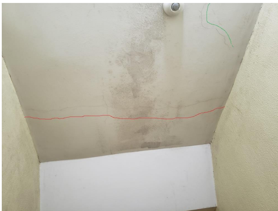
Figura 41 - Fissuras localizadas no corredor de acesso aos apartamentos – foto 1
