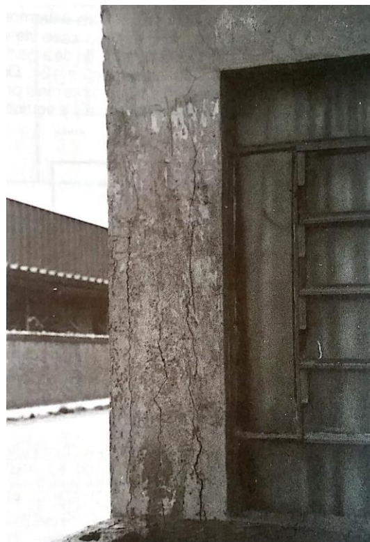
Figura 18 - Fissuras provocadas pela expansão do material, comprometendo irreversivelmente o desempenho da construção.
