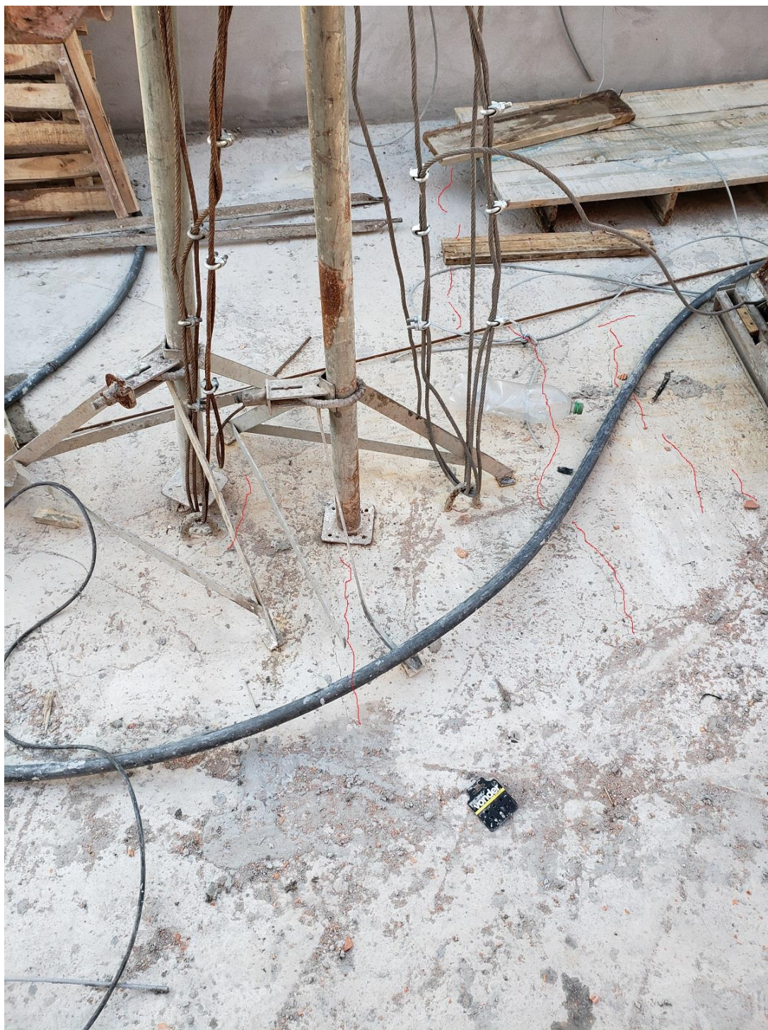
Figura 36 - Fissuras na laje de cobertura em edifício em Capão da Canoa - foto 1
