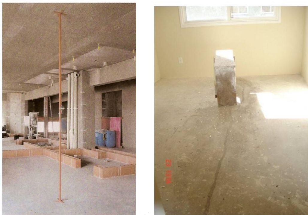
Figura 30 - Exemplos de mau uso de reescoramento, com escoramento no meio do vão da laje e fissura devida à formação de um momento fletor negativo por conta de um reescoramento mal executado.
