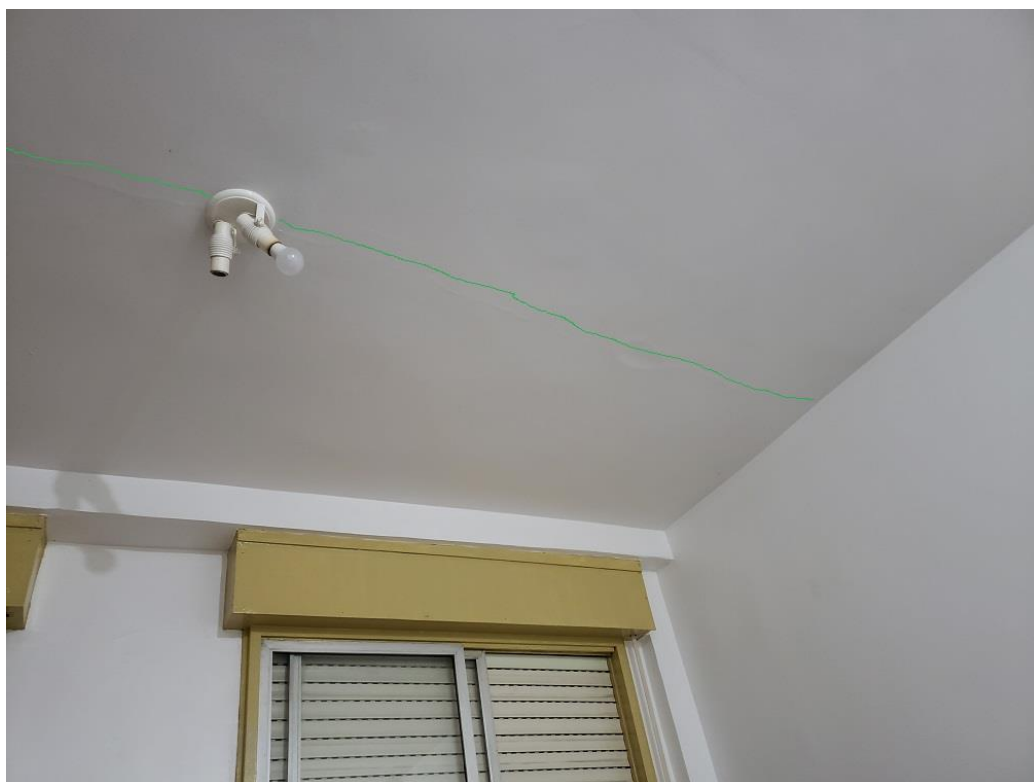
Figura 47 - Fissura localizada na laje do apartamento – foto 1
