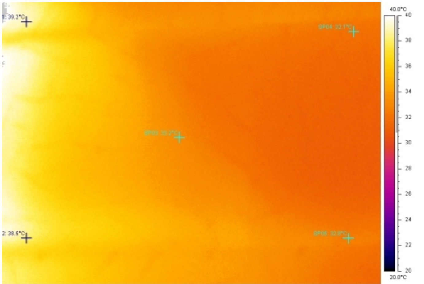
Figura 13: Termograma da placa cerâmica da parede externa da fachada localizada na posição (1;7)
