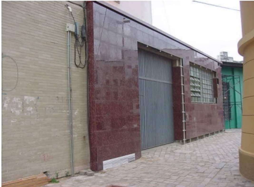
Figura 5: Sistema de fachada ventilada na parede lateral da Engenharia Nova na UFRGS.
