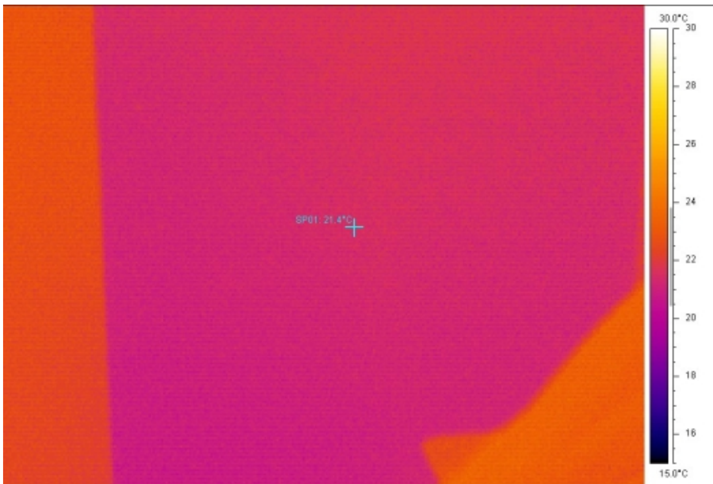
Figura 18: Termograma da parede interna da fachada, na posição correspondente a (5;2).
