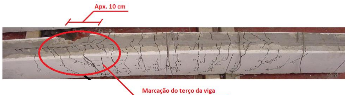
Figura 5.39 - Posição aproximada do início do desprendimento da camada de concreto.
