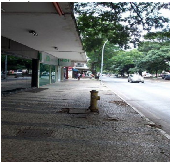
Figura 10 - Calçada localizada em Brasília-DF sem devida manutenção
