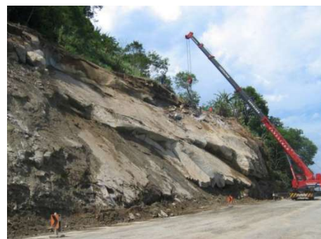
Figura 9 – Ruptura planar em rocha na BR-101, RJ
