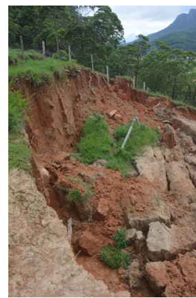
Figura 32 – Detalhe da escarpa na crista do talude
