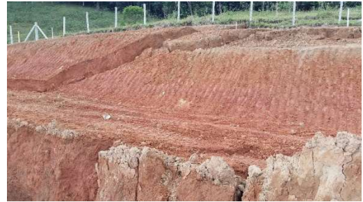
Figura 29 – Detalhe da ruptura junto à cerca existente em julho de 2015
