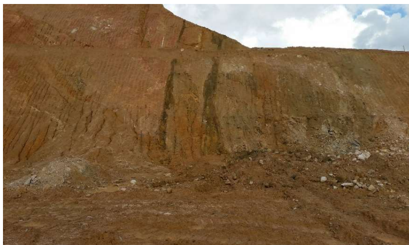
Figura 38 – Diques de diabásio em taludes lindeiros
