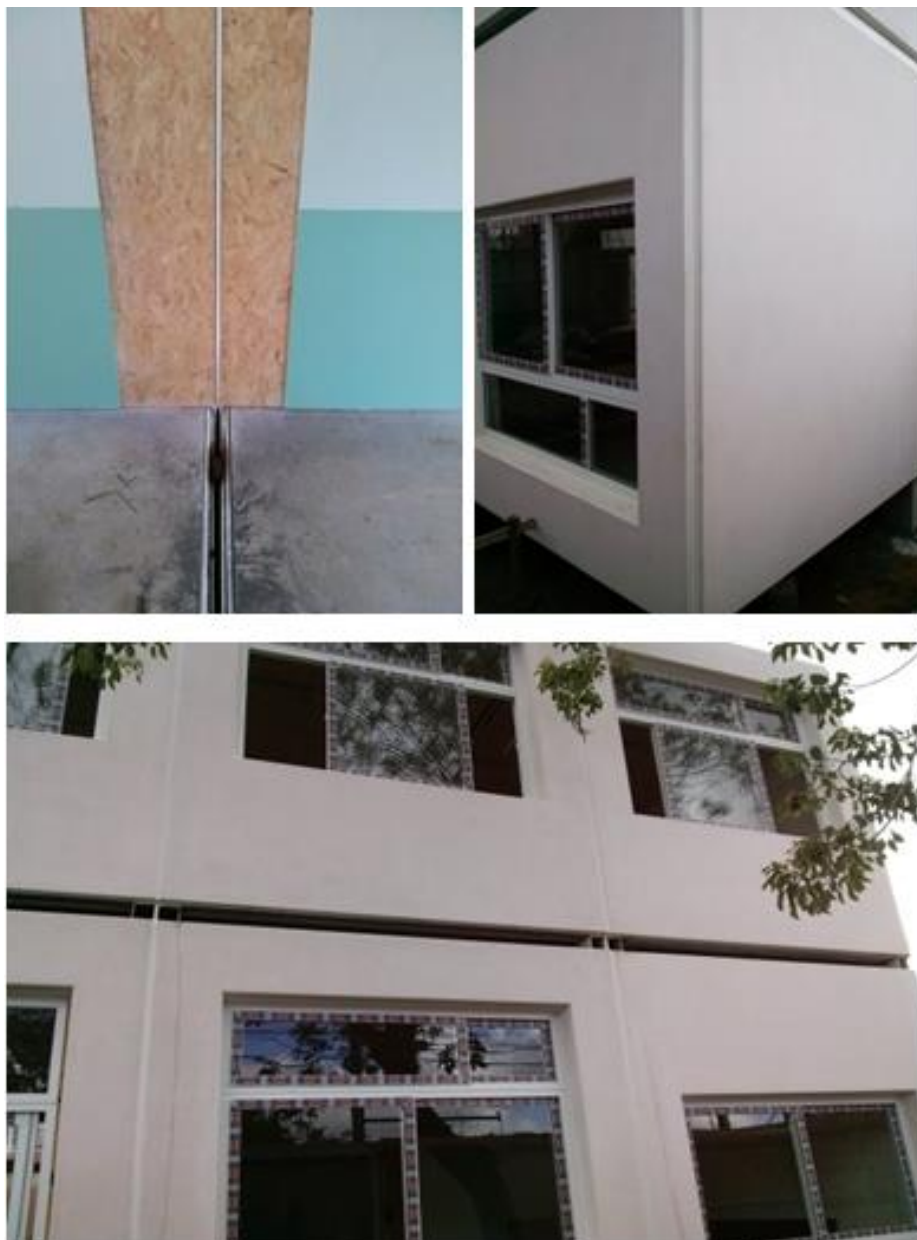
Figura 24 – a) ponto de solda b) e c) juntas na fachada preenchidas com silicone
