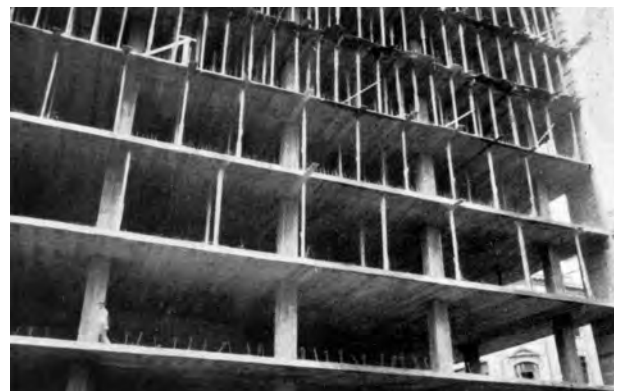
Fig. 4.24 - Marcelo e Milton Roberto : Associação Brasileira de Imprensa, 1936-38. Vista norte do edifício em construção. [COMAS, 2002]
