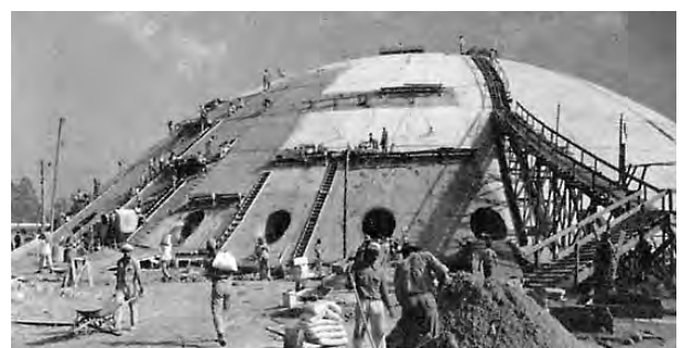
Fig. 4.296 - Oscar Niemeyer: Palácio das Artes (Parque do Ibirapuera), São Paulo, 1953-54. Com a concretagem já completa, é iniciado o revestimento com pastilhas em 1954. [PAPADAKI, 1956]:151
