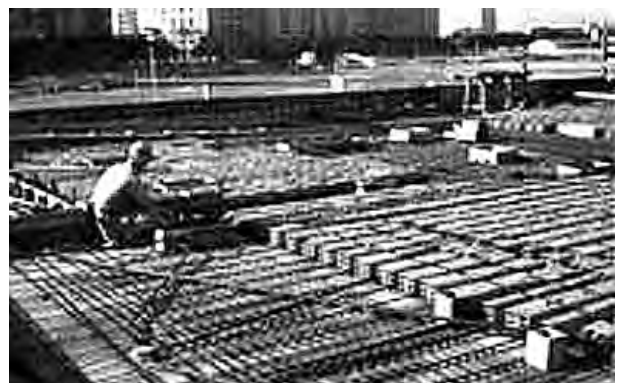
Fig. 4.378 - Affonso Eduardo Reidy: Museu de Arte Moderna, Rio de Janeiro, 1953-58/1967-68. Imagem de janeiro de 1956, mostrando a montagem da laje de concreto com utilização de elementos cerâmicos. [CENTRO DE PESQUISA E DOCUMENTAÇÃO - MAM]
