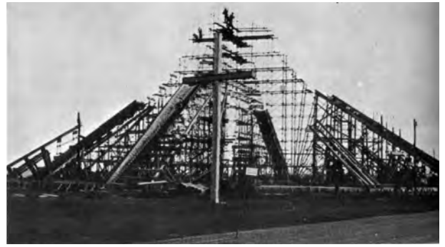
Fig. 4.457 - Oscar Niemeyer: Catedral de Brasília (nave principal), 1959-60. Montagem do cimbramento. [Disponível em < http://abavws.free.fr/jcvasc/catedral.jpg > Acesso em 12 set. 2002]
