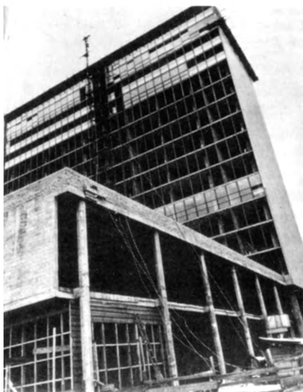
Fig. 4.41 - Lucio Costa e equipe : Ministério da Educação e Saúde Pública, 1936-45. Aplicação das esquadrias no lado sul, com as lajes expostas. [LISSOVSKY, 1996]: 155
