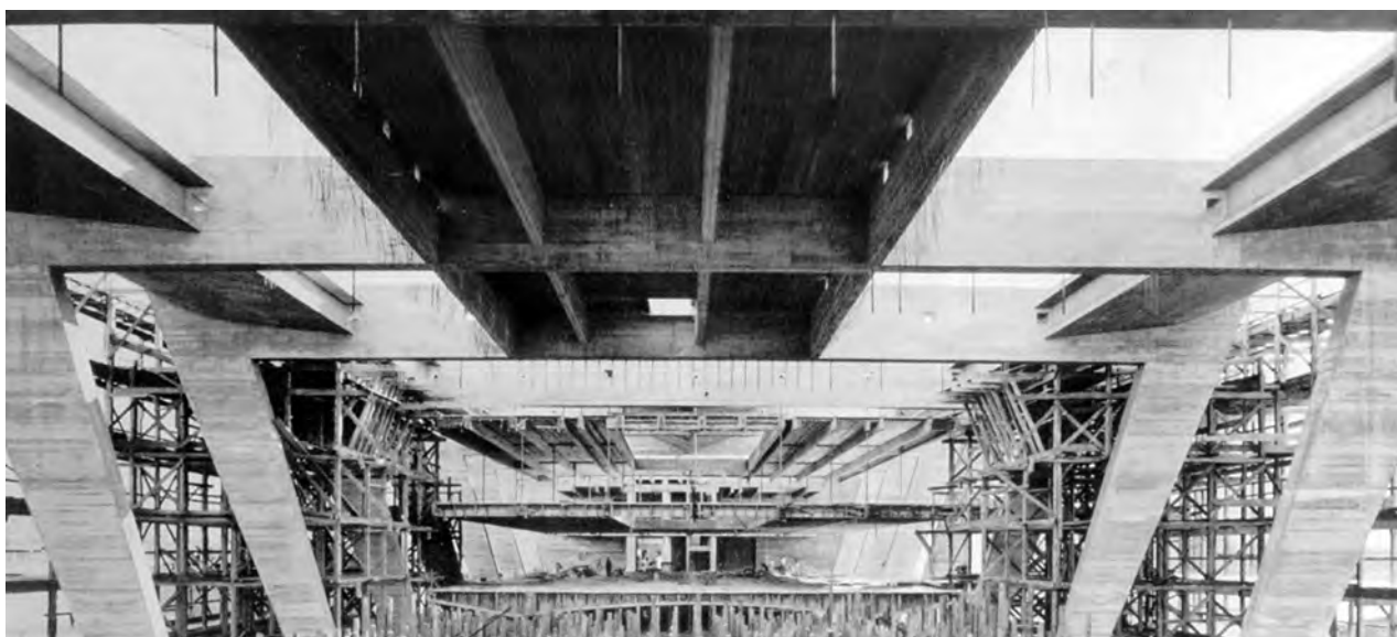
Fig. 4.382 - Affonso Eduardo Reidy : Museu de Arte Moderna, Rio de Janeiro, 1953-58/1967-68. A grande ossatura correspondente a estrutura de pórticos do museu e as lajes parcialmente concretadas. [BONDUKY, 1999]: 173
