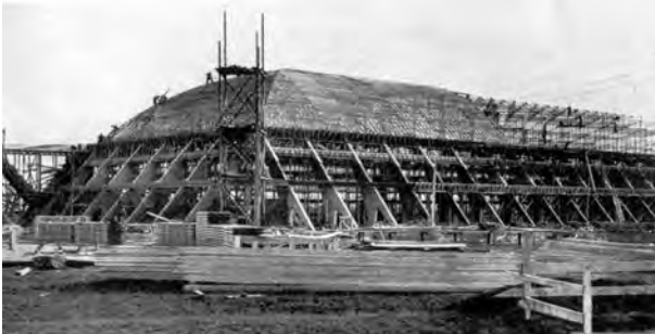
Fig. 2.10 - Pier Luigi Nervi : hangar em Orvieto, 1935. Montagem das armaduras e cimbramento. [DESIDERI, 1982]:33
