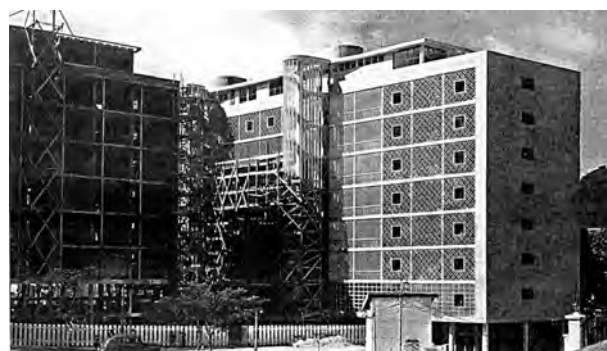
Fig. 4.200 - Lucio Costa: Parque Guinle, Rio de Janeiro, 1947-53. Em 1947 o edifício Nova Cintra (direita) praticamente concluído, quando o bloco central (Bristol, à esquerda) ainda estava em fase de concretagem. [L' Architecture d'Aujourd'hui, n°16 dez 1947]:31
