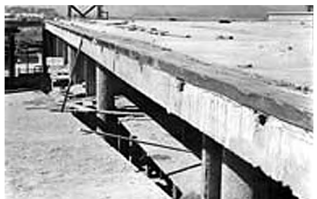
Fig. 4.379 - Affonso Eduardo Reidy: Museu de Arte Moderna, Rio de Janeiro, 1953-58/1967-68. Em maio de 1957 a rampa de acesso bem como a laje do terraço-jardim já havia sido concretada. [CENTRO DE PESQUISA E DOCUMENTAÇÃO - MAM]
