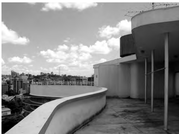
Fig. 4.403 - Oscar Niemeyer : Edifício Oscar Niemeyer, Belo Horizonte/MG, 1954-60. Vista parcial do terraço. [MACEDO, 2002]: fig 144t
