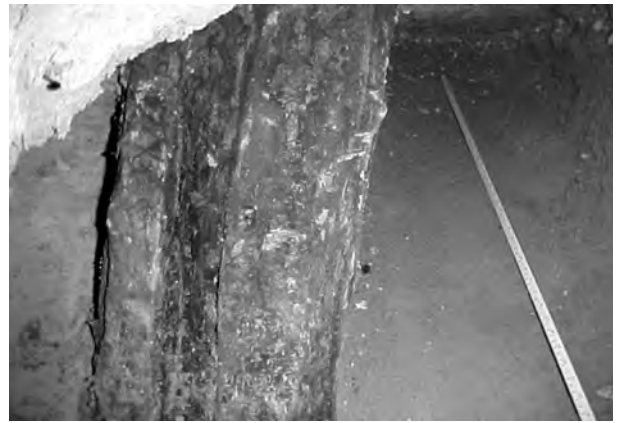
Fig. 4.154 - Oscar Niemeyer: Capela São Francisco de Assis, Belo Horizonte, 1944-45. Imagem de uma das estacas de fundação em madeira. [AGUIAR, 2003]: 04
