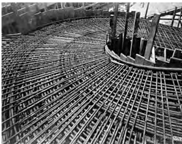
Fig. 4.297 - Oscar Niemeyer : Palácio das Artes (Parque do Ibirapuera), São Paulo, 1953-54. Detalhe das ferragens da rampa interna. [ACRÓPOLE nº191]:496
