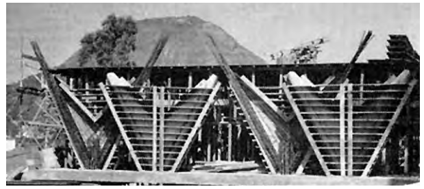
Fig. 4.353 - Oscar Niemeyer e Hélio Uchôa: Hospital Sul-América, Rio de Janeiro, 1952-59. Montagem das formas e armaduras dos pilares em “V” e da primeira laje. [PAPADAKI, 1956]:53
