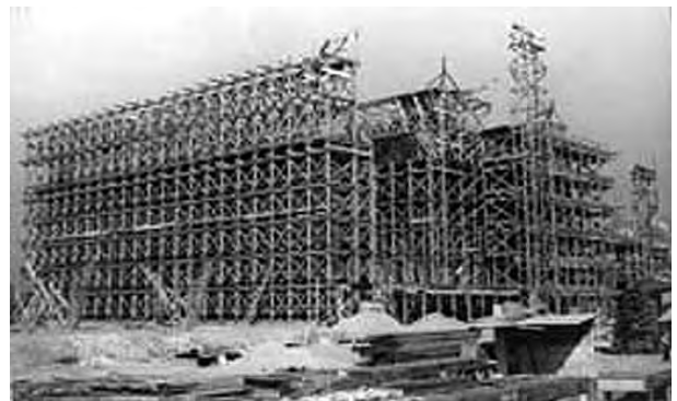
Fig. 4.368 - Affonso Eduardo Reidy : Museu de Arte Moderna, Rio de Janeiro, 1953-58/1967-68. Foto de 1955, com as escoras de madeira que suportavam as formas dos pórticos de concreto. [CENTRO DE PESQUISA E DOCUMENTAÇÃO - MAM]
