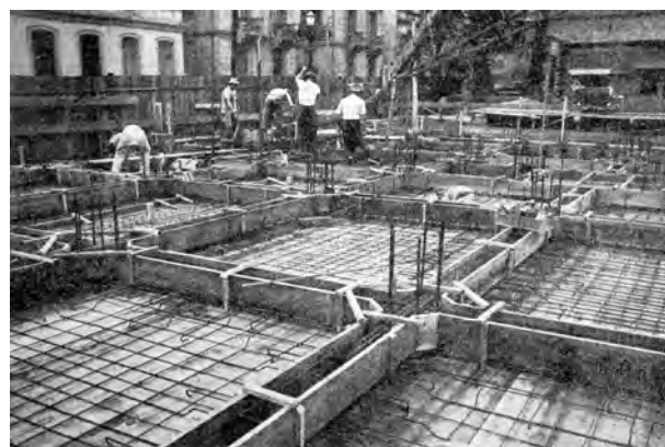
Fig. 4.13 - Álvaro Vital Brazil: Edifício Esther, São Paulo/SP, 1935-38. Montagem de formas e armaduras. [REVISTA POLITÉCNICA, 1938]:229
