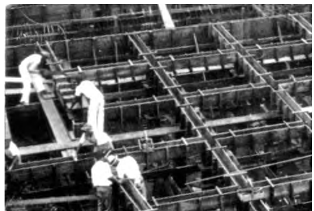
Fig. 4.81 - Marcelo e Milton Roberto: Aeroporto Santos Dumont, Rio de Janeiro, 1937-44. Armação das formas da grelha estrutural. [VESPUCCI, 1996]
