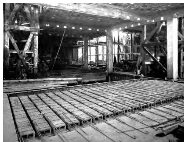
Fig. 3.09 - Gordon & Guton: The British-American Tobacco Co., LTD. , Londres, 1913. Distribuição das peças cerâmicas e montagem das ferragens. [CONCRETE and Constructional Engineering, nov. 1913 Vol. VIII n°11]: 750
