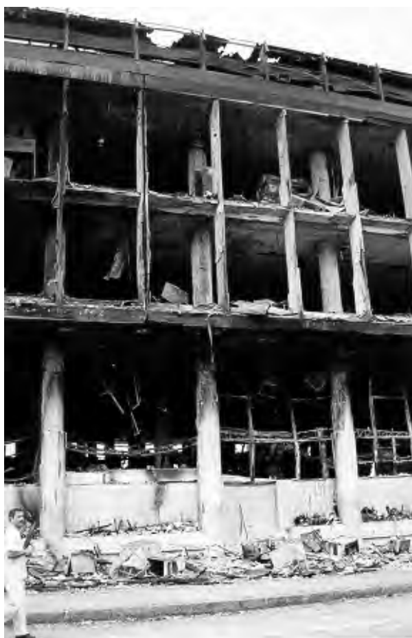
Fig. 4.78 - Marcelo e Milton Roberto : Aeroporto Santos Dumont, Rio de Janeiro, 1937-44. Aspecto da estrutura após o incêndio. [BATTISTA, 2001]
