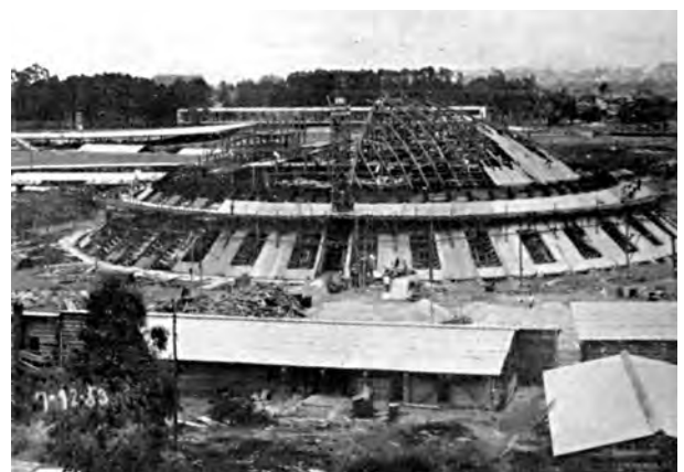
Fig. 4.295 - Oscar Niemeyer: Palácio das Artes (Parque do Ibirapuera), São Paulo, 1953-54. Em 7 de dezembro de 1953 o aterro já havia sido feito até a altura do nível de acesso. [ACRÓPOLE n°191]:496
