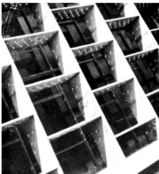
Fig. 4.272 - Oscar Niemeyer e equipe: Palácio das Nações e dos Estados (Parque do Ibirapuera), São Paulo, 1951-53. Detalhe dos brises alveolares. [ACRÓPOLE, nº185]: 213
