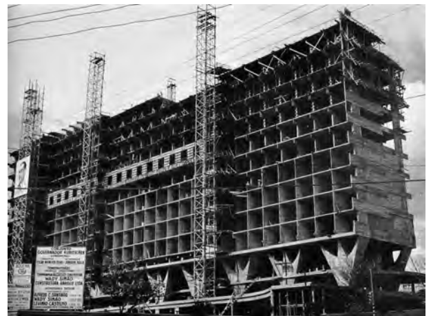
Fig. 4.320 - Oscar Niemeyer : Edifício Governador Kubitschek, Belo Horizonte, 1951. O prédio em construção e as paredes em concreto, com a primeira laje (sobre os pilotis) com maior espessura. [PAPADAKI, 1956]:51
