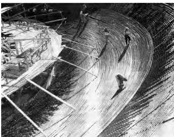
Fig. 4.440 - Oscar Niemeyer : Congresso Nacional, Brasília, 1956-60. Detalhe da montagem das armaduras. [BRASÍLIA nº30]: 04
