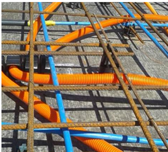
Figura 20 – Interferência das cordoalhas com instalações
