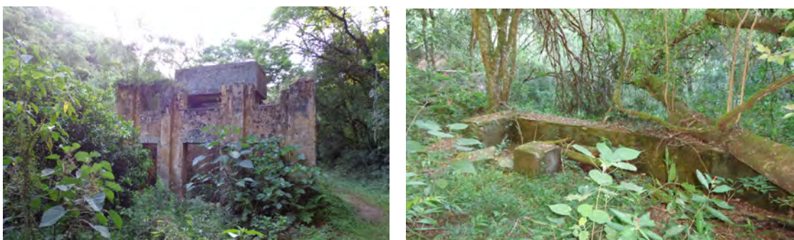
Figura 126 e 127: a primeira figura é a antiga casa de máquinas em ruínas próxima à represa de tomada. Próximo a essa, a segunda figura são as ruínas da casa do zelador da barragem. Fotos do autor em 2012.
