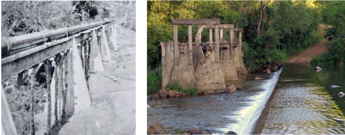
Figuras 128 e 129: “Passo do Macaco” com as adutoras. Na primeira figura (INTENDÊNCIA, 1930), a adutora passa por cima do rio, no ponto A marcado na figura 104. Na segunda figura, foto do autor em 2012, mesma estrutura, em ruínas, já alterada para comportar duas adutoras que foram relocadas e envelopadas para junto do rio, servindo a estrutura em concreto também para passagem de veículos.
