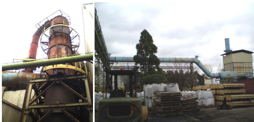
Figura 77: Sistema de captación de gases, humos y polvo
