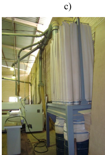
Figura 46. Sistemas tipos de retenção de material particulado: a) silo tipo ciclone, b) silo com filtros de manga e c) sacos coletores. Fotos da autora.
