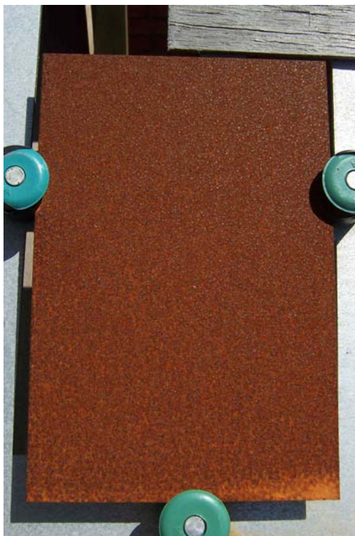
Figura 7: Peça de aço após exposição às intempéries no litoral, mostrando carepa formada por produtos corrosivos.
